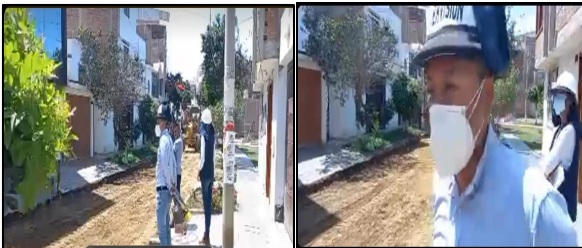
Visita a obra de la tesista en la pavimentación de las calles de la Urb. Cortijo, sector Natasha Alta, Trujillo
