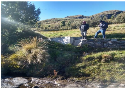
(DESARENADOR EXISTENTE CON FALLAS RUSTICAS)
