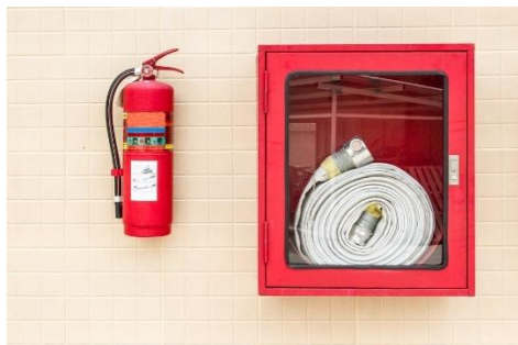
N° 122: Gabinete de Manguera contra Incendio
