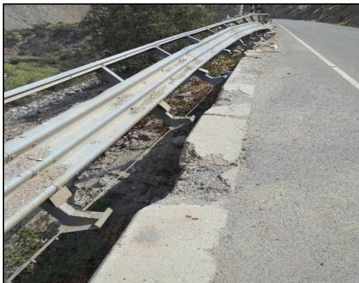
Figura 5: Despliegue de la barrera de seguridad del muro de concreto
