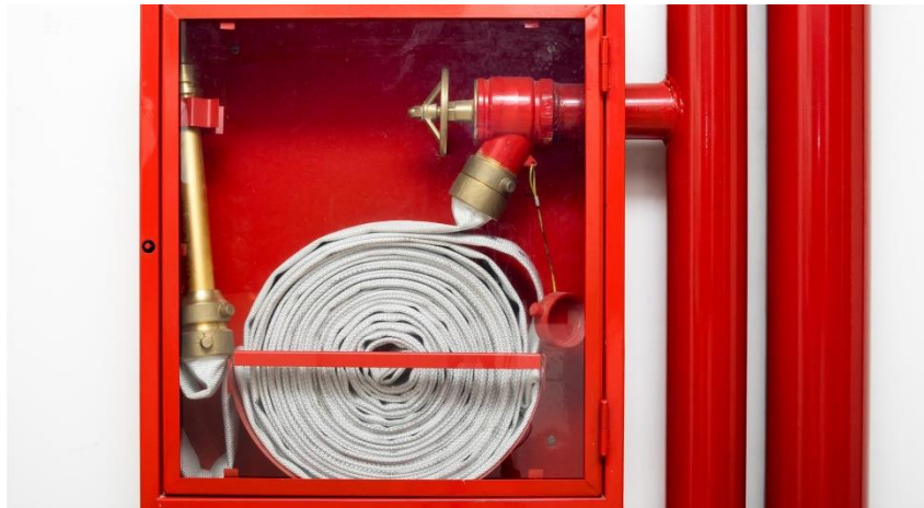
Figura 64: Gabinete contra incendios
