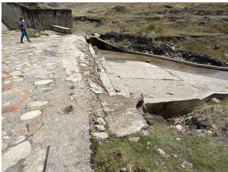
Figura N°31: Salida de la poza disipadora deteriorada
