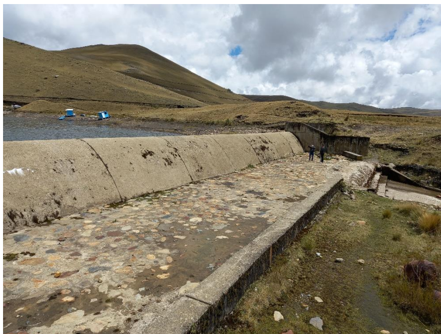
Figura N°30: Barraje y poza disipadora en mal estado
