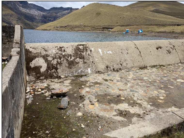
Figura N°2: Poza disipadora y barraje deteriorados
