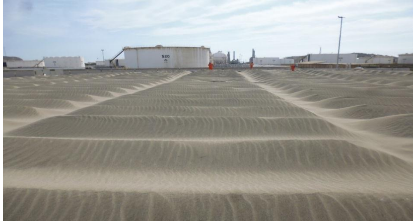
Fotografía 13: Vista de arena catódica dentro del anillo de concreto.
