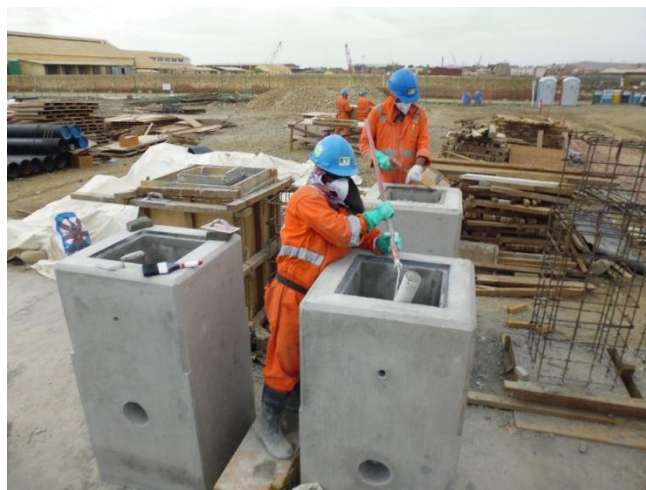
Fotografía 14: Vista de buzones detectores de fuga prefabricados.
