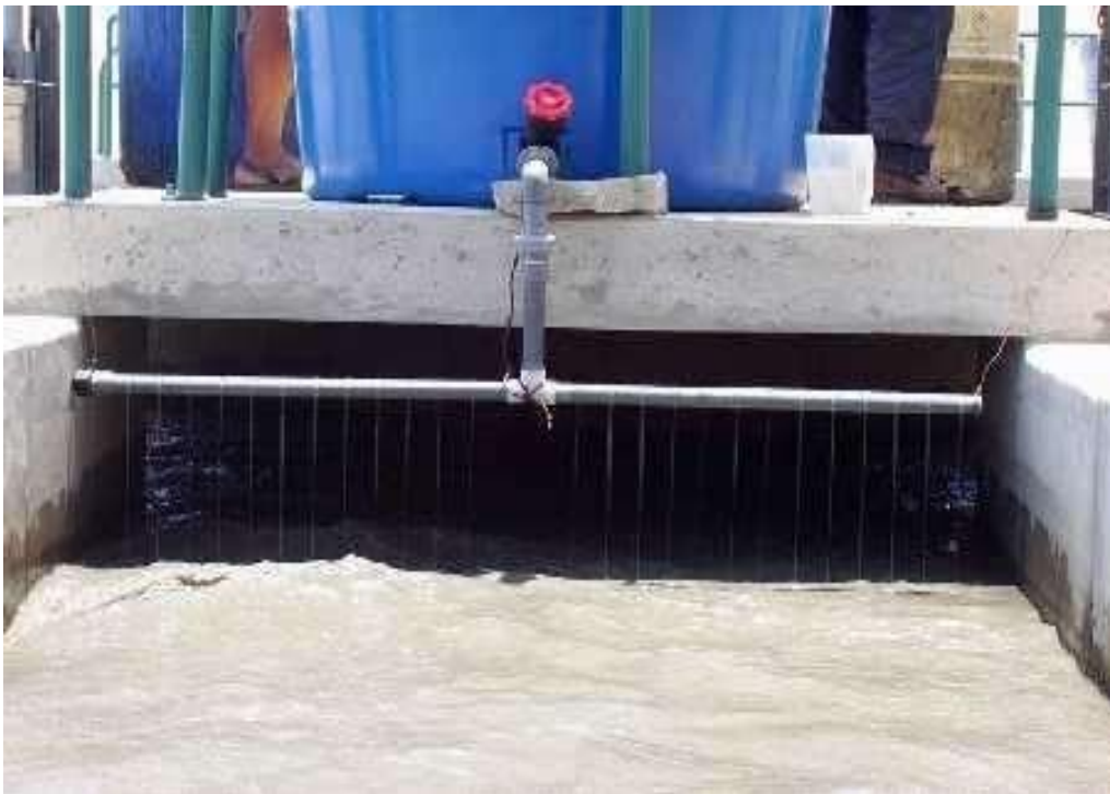
Figura 13 Inyección de floculante
