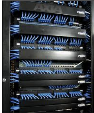
Figura N° 13 VISTA DE UN RACK
