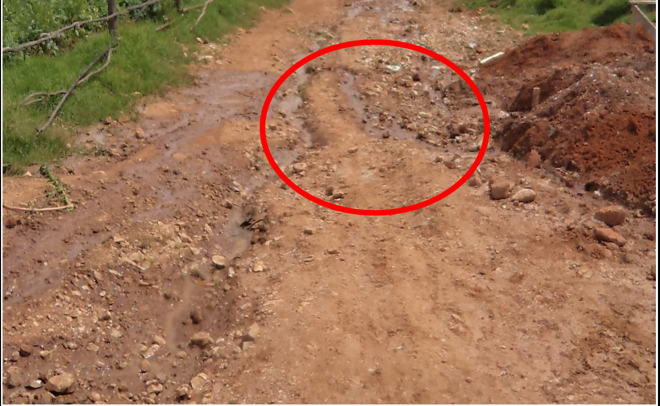
FOTO 1: AV. DEL EJERCITO CUADRA N° 5 (Se Observa el Mal estado de la Calle y de las Cunetas)
