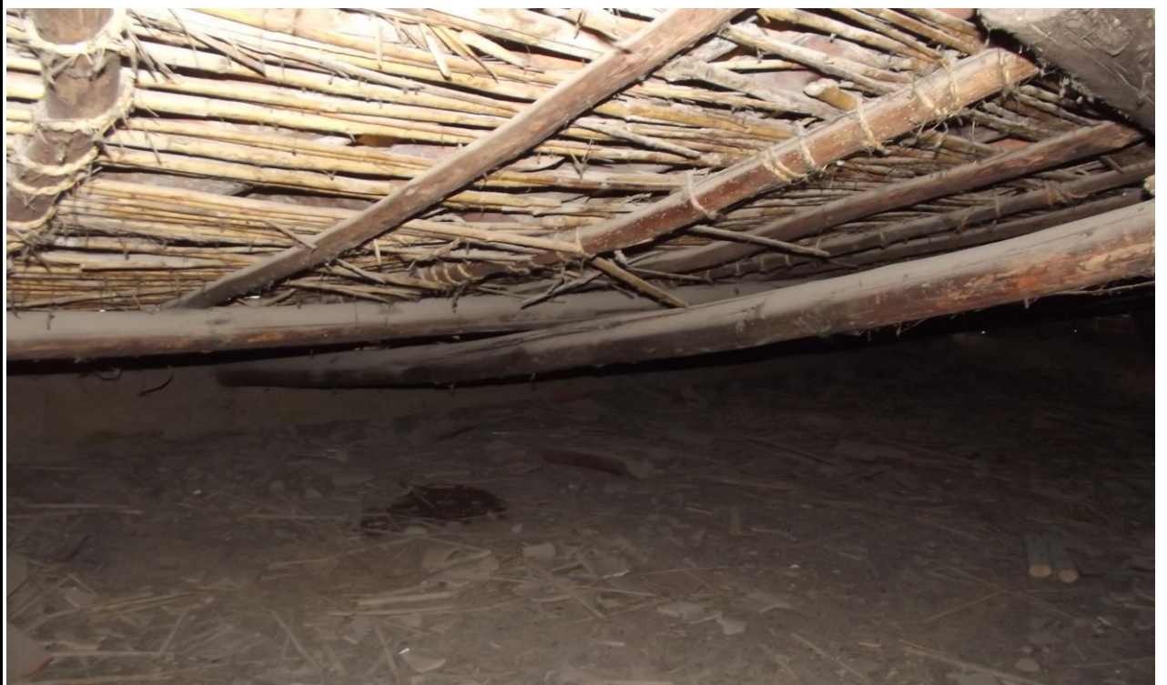
FOTO 4: Estructura de Madera de la Cobertura en Mal Estado
