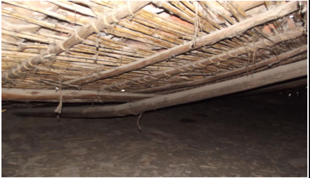
FOTO 3: Estructura de Cobertura del Local Ex Policia - Municipalidad Provincial Sanchez Carrion Huamachuco en Mal Estado
