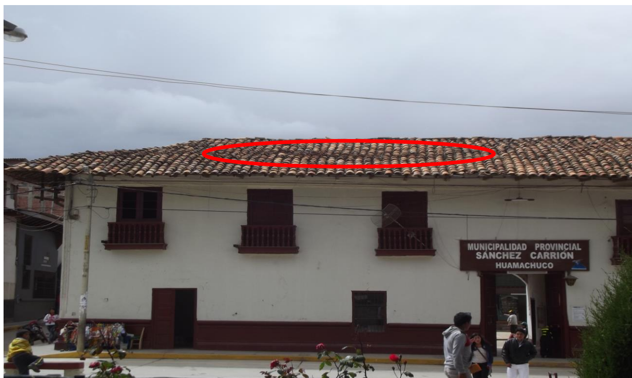
FOTO 6: Cobertura Teja en Mal Estado y con Hundimiento Parcial.
