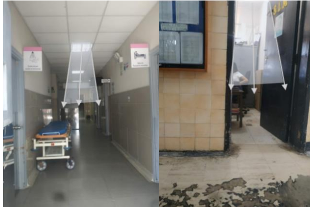
Imagen N° 12: Pasillos y oficinas sin iluminación natural
