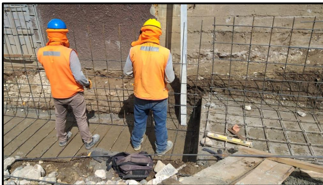
Habilitación y armado de acero para el muro de contención de concreto armado en Jr. Nacarino.
