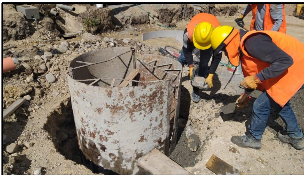
Encofrado y vaciado de buzón para llegar al nivel de afirmado en el Jr. Nacarino.
