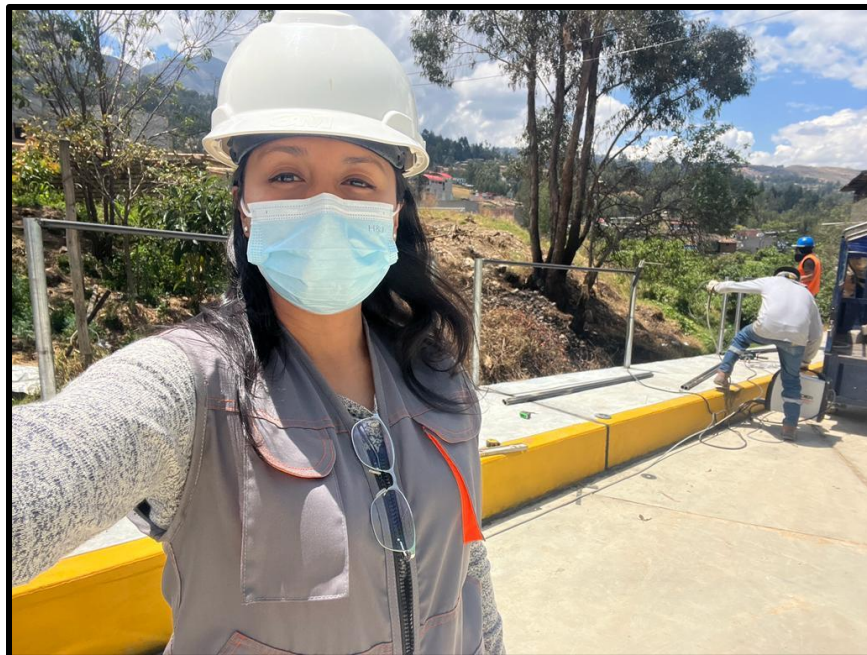
Habilitación de baranda metálica sobre vereda que se encuentra sobre el muro de contención existente.
