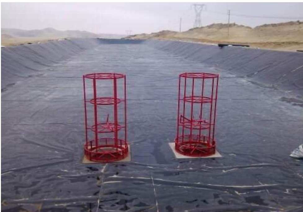
Imagen 11 . Ubicación del reservorio e impermeabilización con geomembrana
