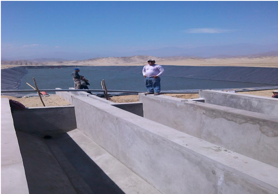
Imagen 10 . Decantador para sedimentar limos y arcillas
