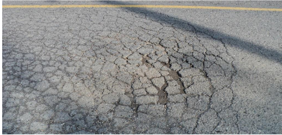
Figura N° 03 Grietas de Contracción o de bloque.
