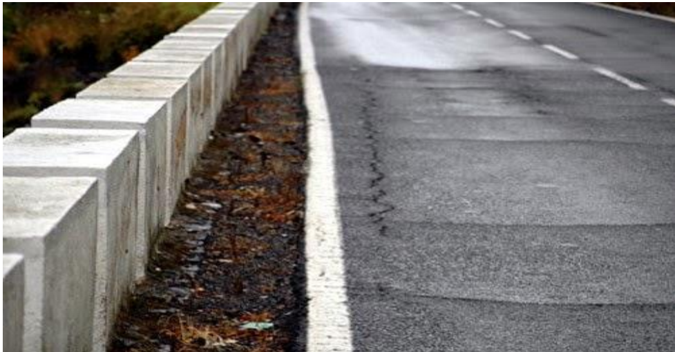
Figura Nº 10 Grietas de borde
