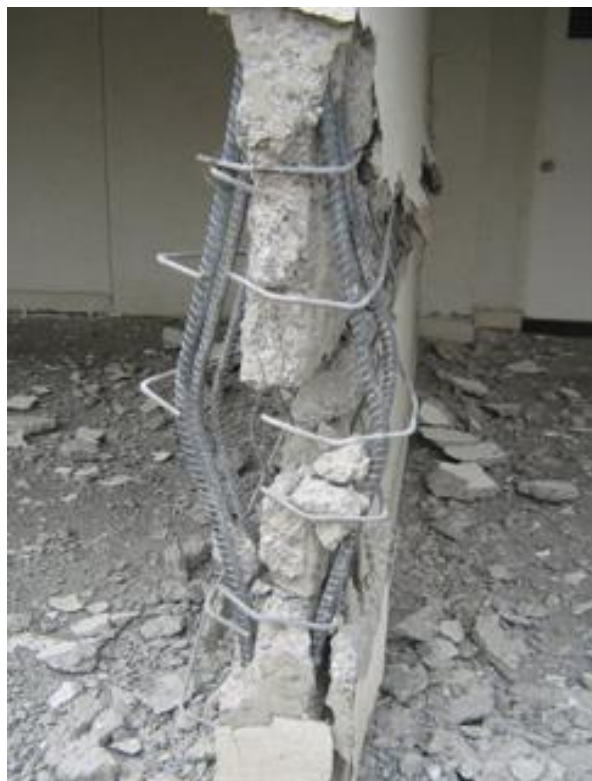
Figura 1.- Cantidad de Estribos insuficiente y sin ganchos sísmicos. (2011). Centro de investigaciones periódicas. Chile.
