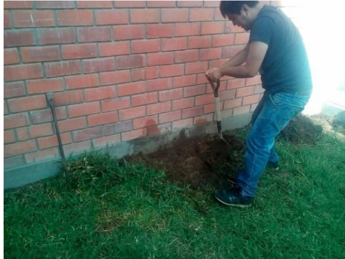
Figura N° 30: Excavación en la pared de la vivienda, donde se verifico que existe cubiertas para evitar la humedad y deterioro de los sulfatos a la cimentación de la vivienda.
