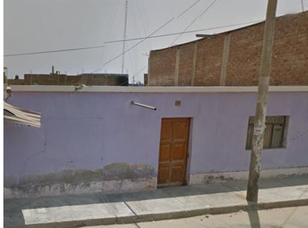
Figura N° 26: Casa típica de material noble, donde se visualiza la humedad en la fachada.
