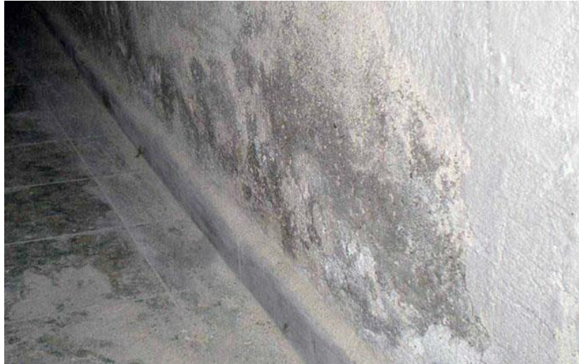
Fotografía N° 04: Vista de muros empapados de agua hasta esa altura y con presencia de sales producto del ascenso capilar de la humedad.
