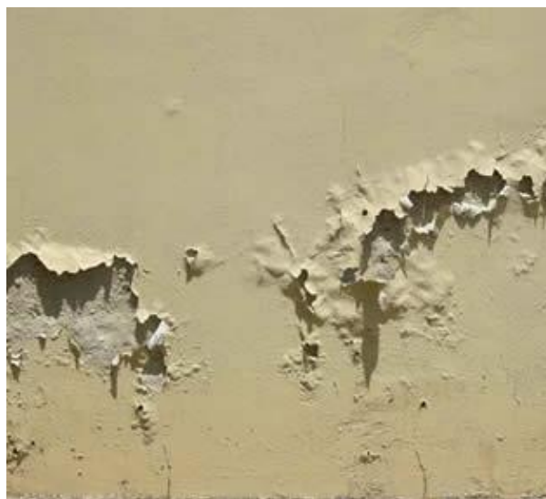
Figura N° 08: Pintura deteriorada por la humedad
