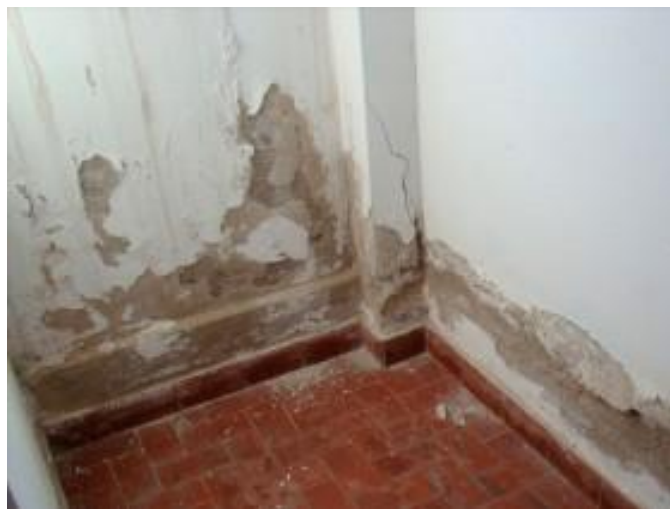
Figura N° 07: Humedad presente en columna que pone en peligro la estabilidad de la estructura
