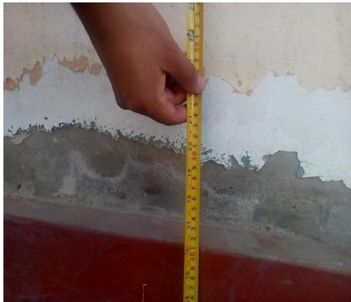
Figura N° 23: Altura capilar del exterior de una vivienda.
