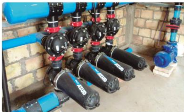
Figura 2.14. Equipo de riego con filtrado de anillas
