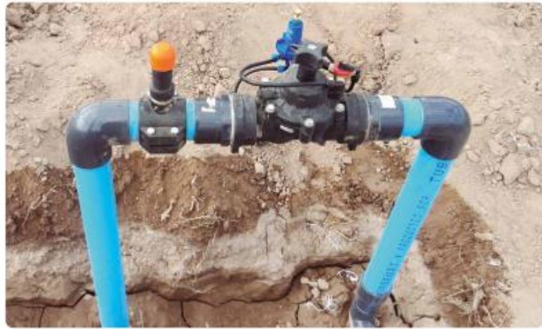
Figura 2.18. Cabezales de campo con válvula hidráulica instalada
