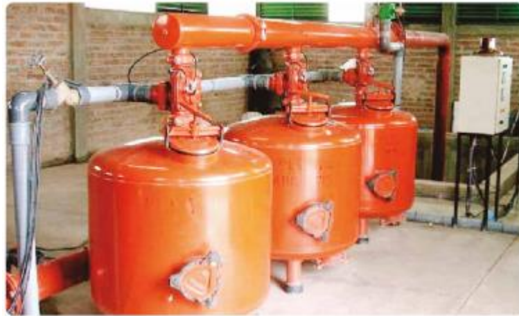
Figura 2.9. Conjunto de filtros de gravas
