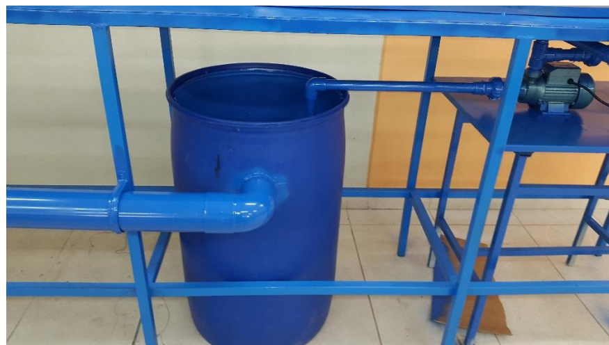
Figura N° 4-3. Pozo Disipador Fuente: Universidad Privada Antenor Orrego (2016)
