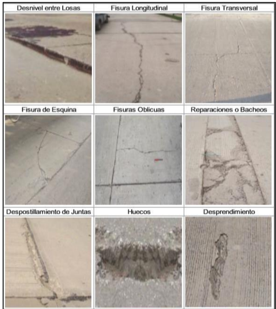
Figura 10. Daños en Pavimento Rígido
