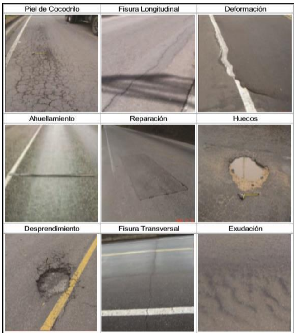
Figura 11. Daños en Pavimento Flexible
