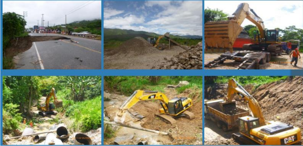
Fotografía N° 05: Vistas de erosión de plataforma carretera. Junín
