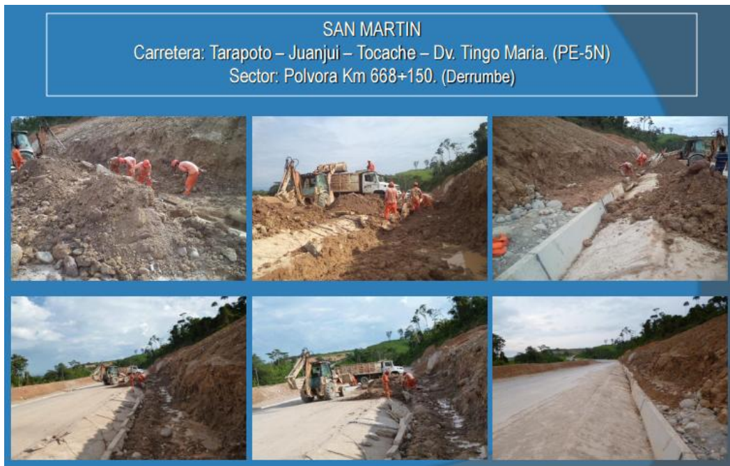
Fotografía N° 02: Vistas de derrumbes en carretera Tarapoto. San Martín
