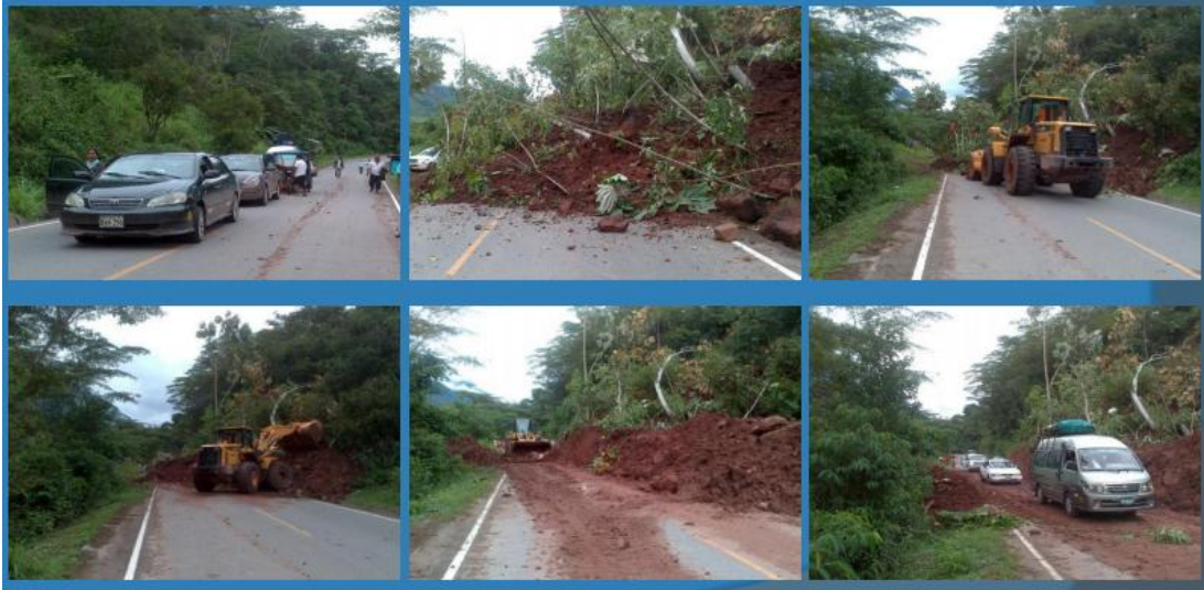
Fotografía N° 06: Vistas de derrumbes carretera. Junín
