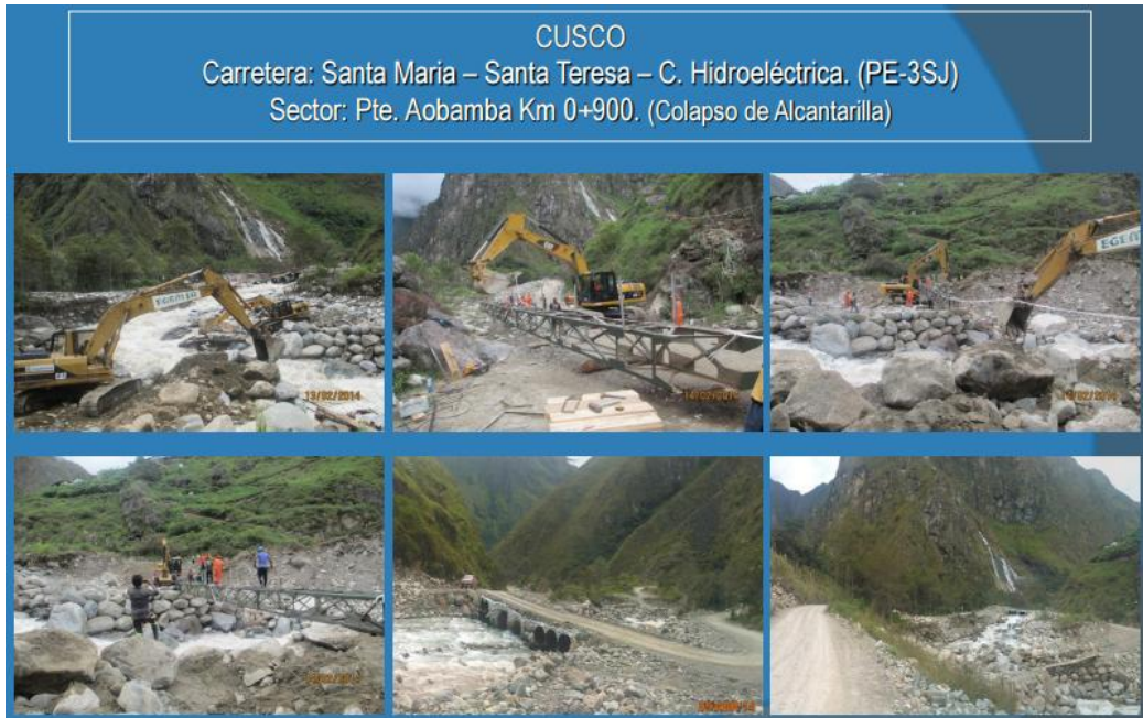
Fotografía N° 03: Vistas de colapso de alcantarilla .Cuzco.
