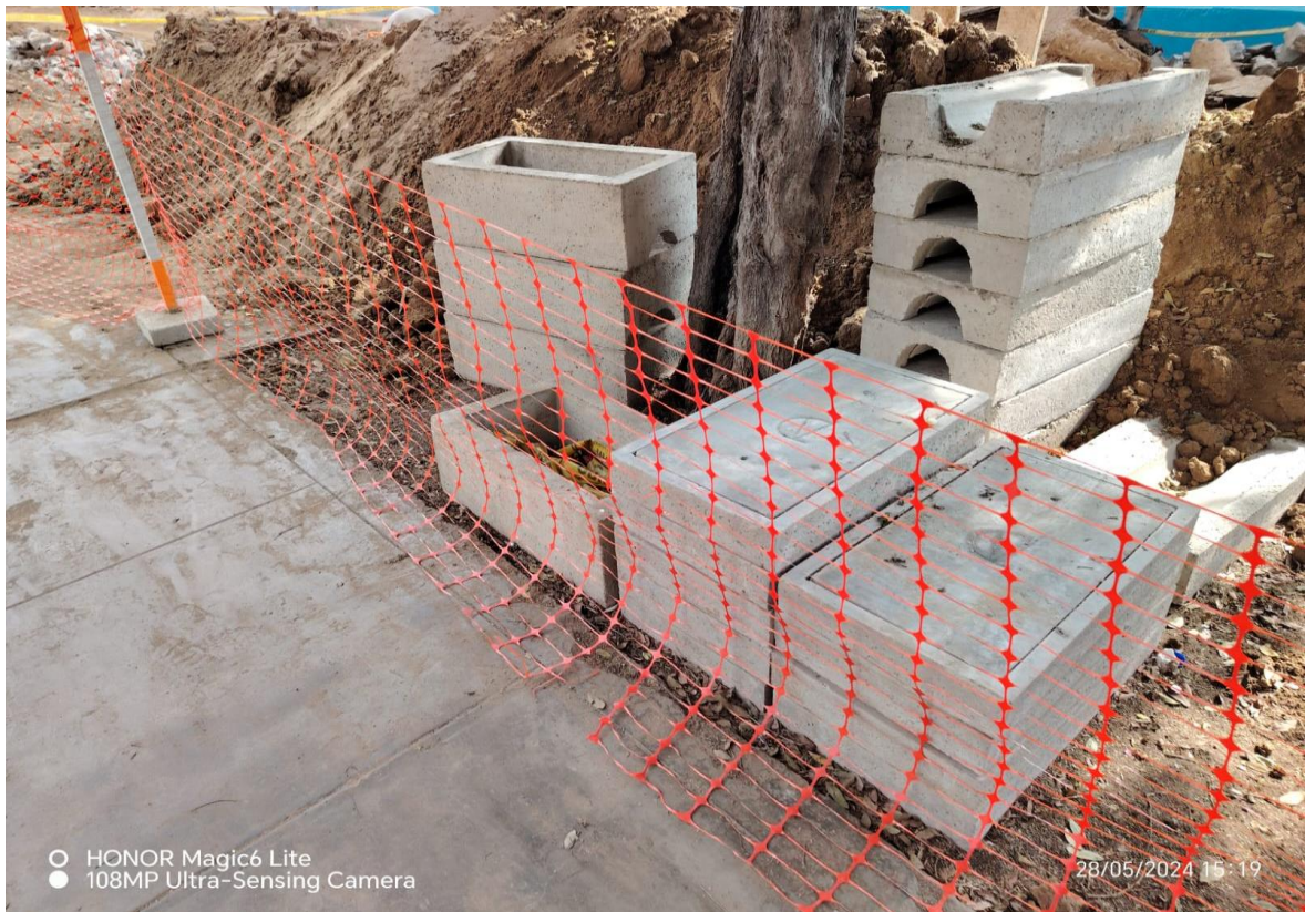
FIGURA 7: Acopio de tapas de desagüe
