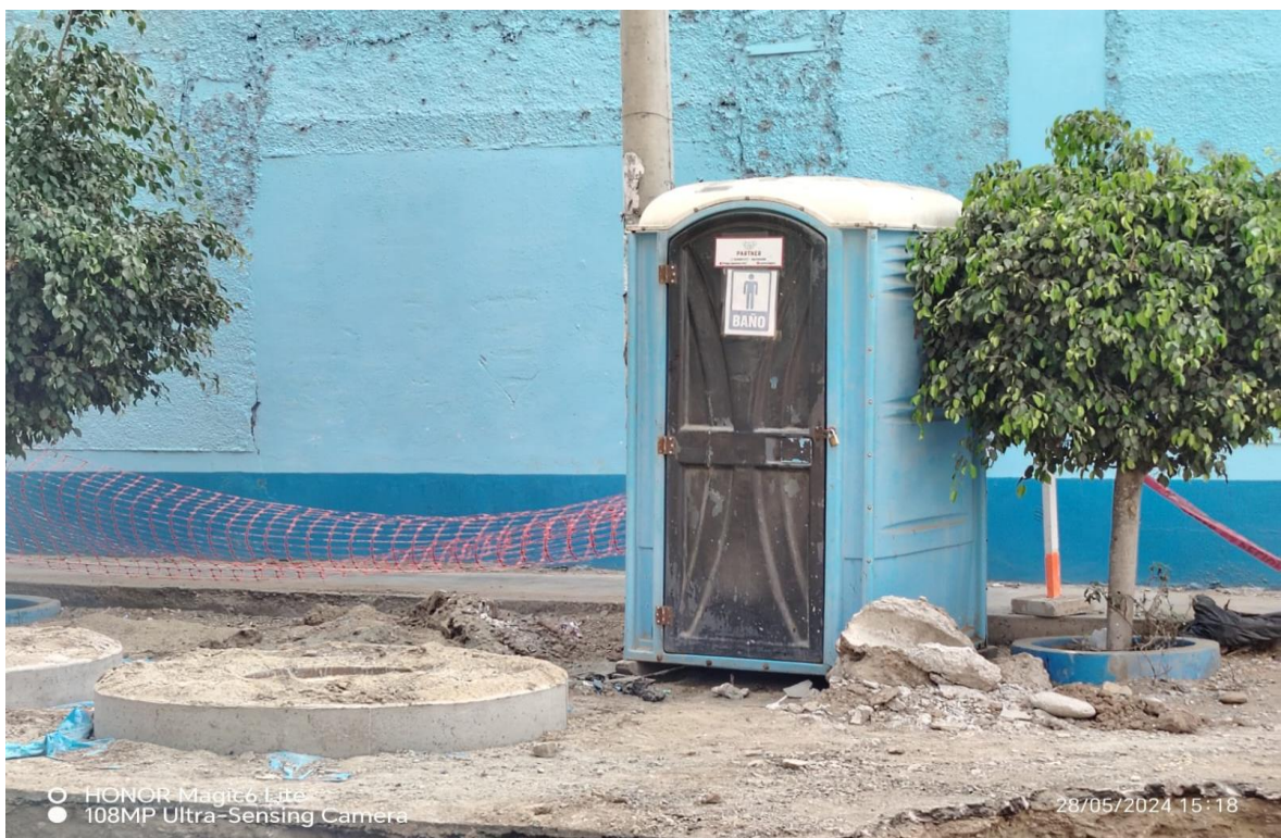
FIGURA 8: Instalaciones de baño público para los trabajadores
