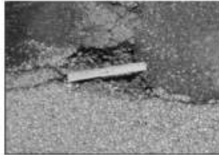
Figura 11.32 Baches – Severidad baja
