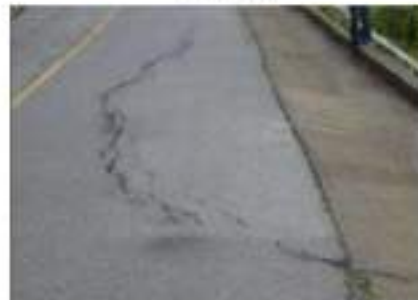
Figura 11.43 Grietas parabólicas – Severidad media
