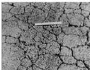
Figura 11.3 Piel de cocodrilo – Severidad alta
