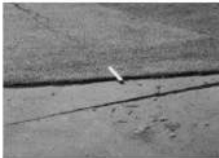
Figura 11.40 Desplazamiento – Severidad media
