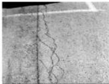
Figura 11.20 Fisura de Borde – Severidad media
