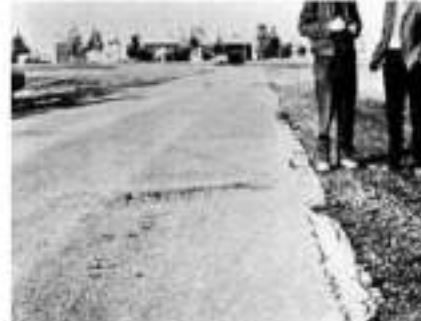
Figura 11.37 Ahuellamiento – Severidad media
