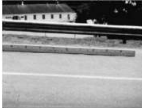
Figura 11.13 Corrugación – Severidad baja
