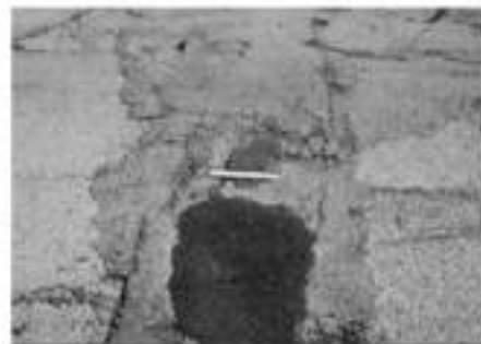
Figura 11.30 Parches – Severidad alta
