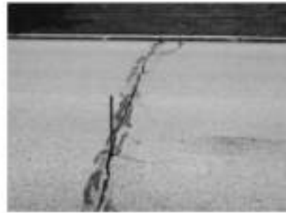
Figura 11.26 Fisuras Longitudinales y Transversales – Severidad media
