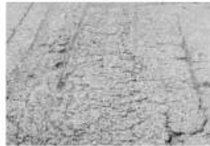
Figura 11.47 Desprendimiento de agregados – Severidad media
