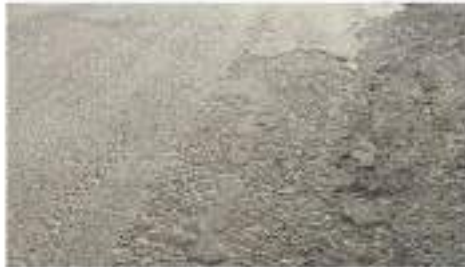
Figura 2.11 Desprendimiento de agregados – UM5
