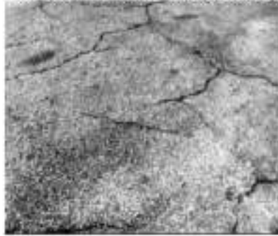
Figura 11.9 Fisuras en Bloque – Severidad alta
