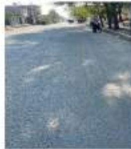
Figura 2.6 Desprendimiento de agregados UM3
