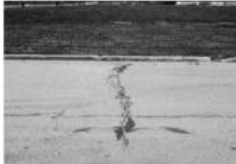
Figura 11.27 Fisuras Longitudinales y Transversales – Severidad alta
