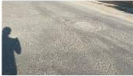
Figura 2.9 Desprendimiento de agregados – UM4
