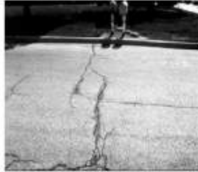
Figura 11.8 Fisuras en Bloque – Severidad media
