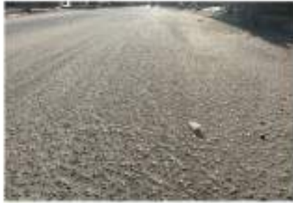
Figura 2.15 Desprendimiento de agregados – UM7
