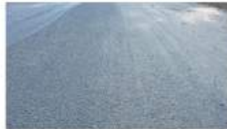
Figura 2.18 Desprendimiento de agregado – UM8
