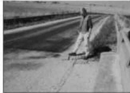
Figura 11.39 Desplazamiento – Severidad baja
