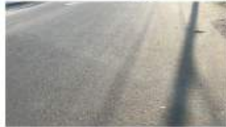
Figura 2.20 Desprendimiento de agregados – UM9
