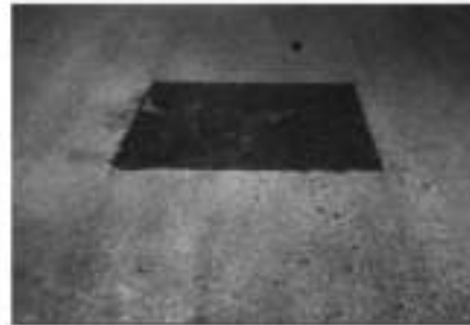
Figura 11.28 Parches – Severidad baja
