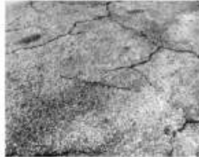
Figura 11.10 Abultamiento y Hundimiento – Severidad baja
