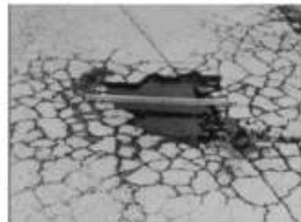
Figura 11.35 Baches – Severidad alta
