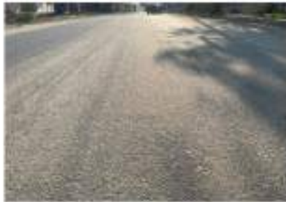
Figura 2.23 Desprendimiento de agregados – UM11
