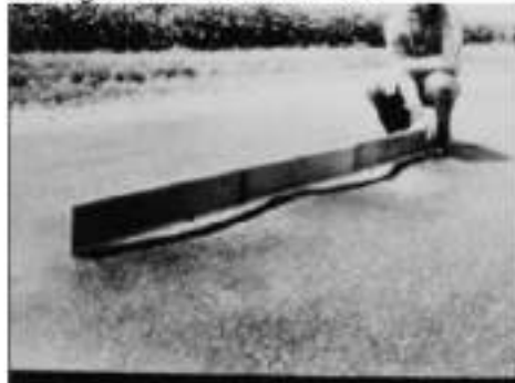
Figura 11.15 Corrugación – Severidad alta
