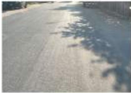
Figura 2.21 Desprendimiento de agregados – UM10
