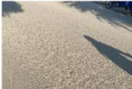
Figura 2.13 Desprendimiento de agregados – UM6
