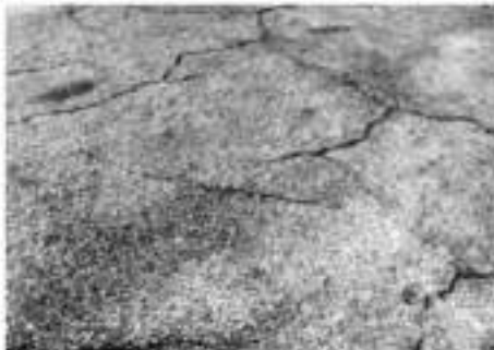
Figura 11.36 Ahuellamiento – Severidad baja
