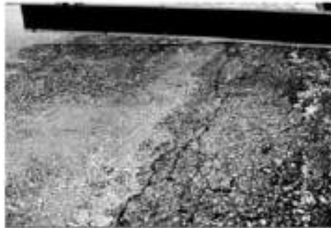
Figura 11.38 Ahuellamiento – Severidad alta
