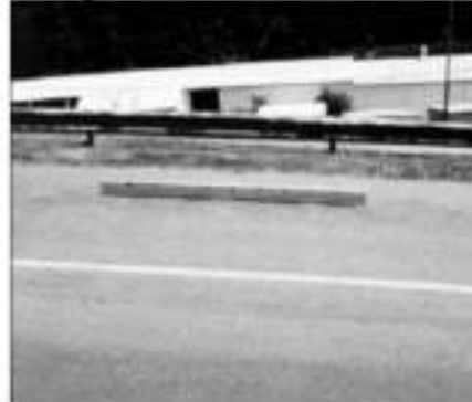
Figura 11.14 Corrugación – Severidad Media
