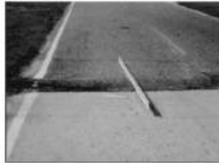
Figura 11.41 Desplazamiento – Severidad alta
