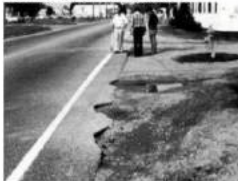
Figura 11.21 Fisura de Borde – Severidad alta
