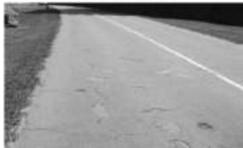
Figura 11.48 Desprendimiento de agregados – Severidad alta
