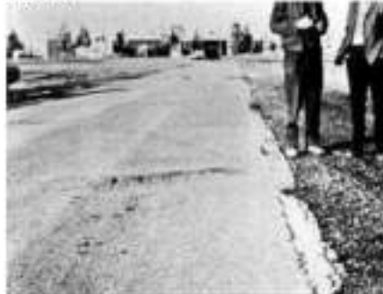
Figura 11.11 Abultamiento y Hundimiento – Severidad media
