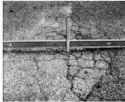
Figura 11.18 Depresión – Severidad alta
