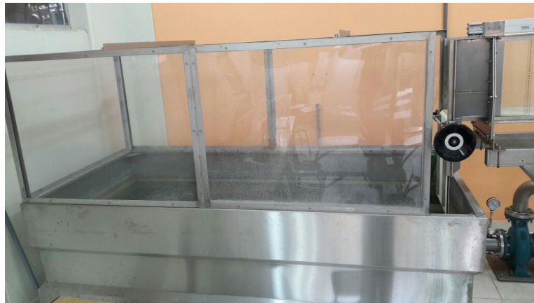
Fotografía 01.- Tanque de Almacenamiento y bomba de impulsión. (UPAO)
