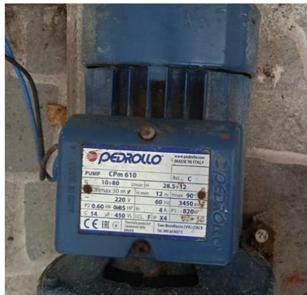
Figura 17. Electrobomba de agua instalada en domicilio.
