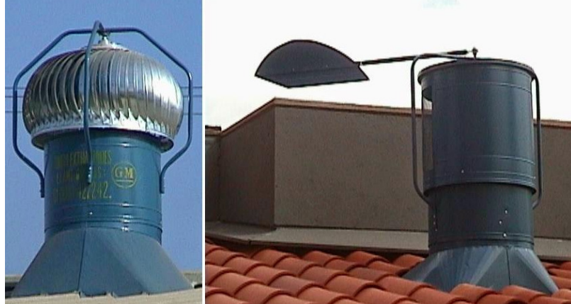
Fotografía N° 06 : Vista de extractores
