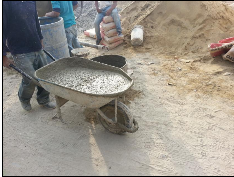
FOTO PROYECTO L. Mezcla de concreto con exceso de contenido de humedad.
