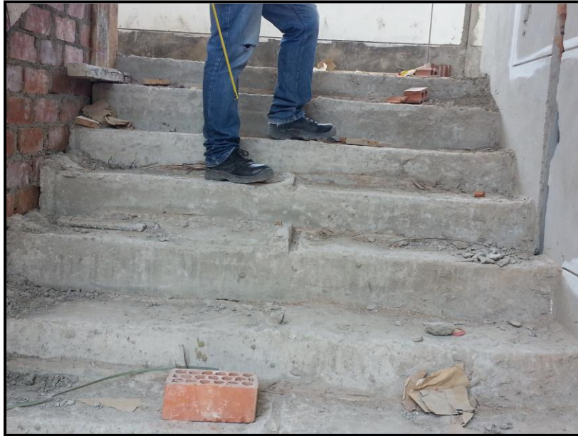
FOTO PROYECTO L. Vaciado de concreto defectuoso en escaleras.
