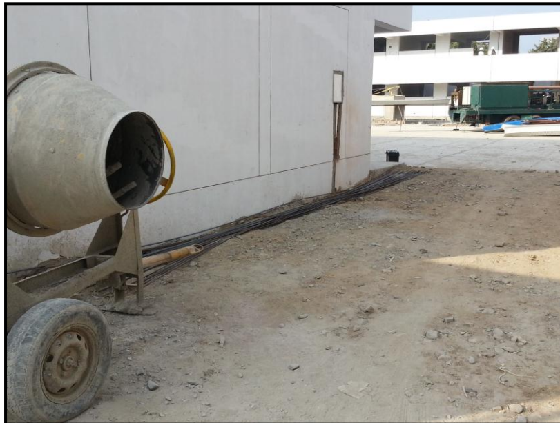
FOTO PROYECTO L. Mezcladora de concreto sucia y acero almacenado en contacto directo con el suelo.
