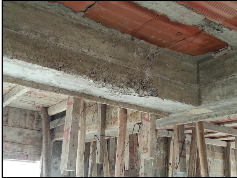
FOTO PROYECTO A. Viga con presencia de cangrejas.
