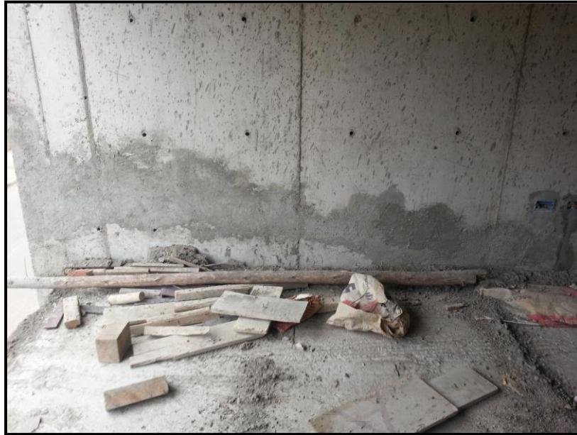
FOTO PROYECTO A. Placa con cangrejas resanadas, producto de falta de vibrado a la hora del vaciado.
