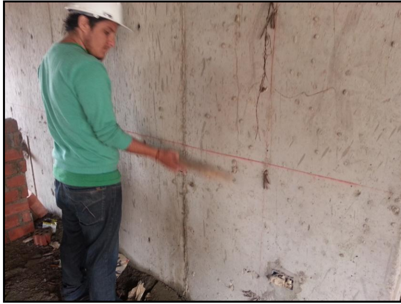
FOTO PROYECTO A. Placa con irregularidades en su superficie (superficie no plana) producto de deficiencias a la hora de asegurar el encofrado.
