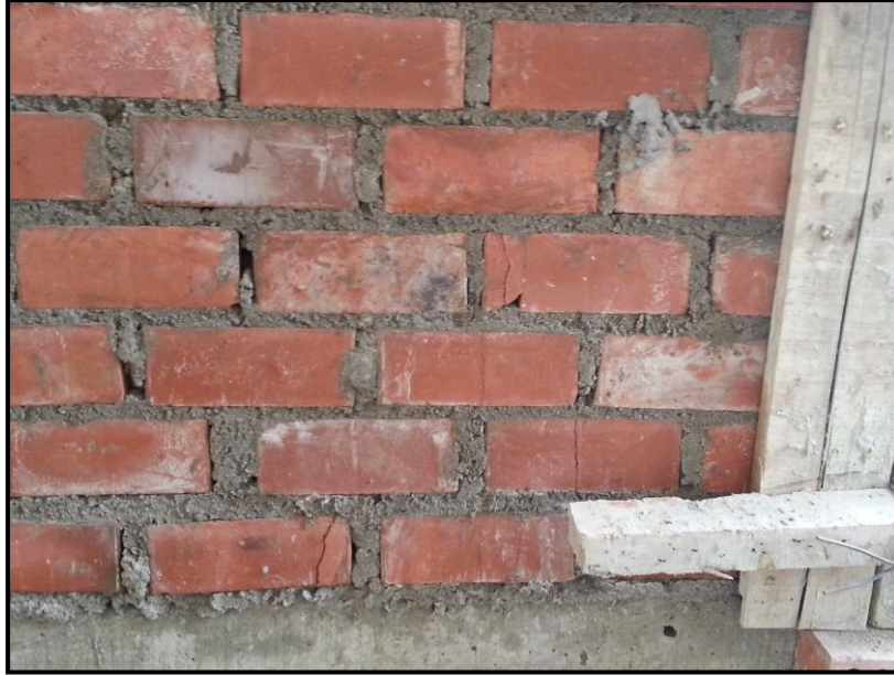
FOTO PROYECTO L. Unidades de albañilería rotas y espesor de mortero inadecuado.
