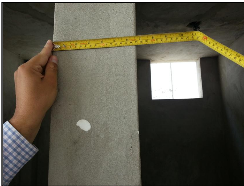
FOTO PROYECTO L. Muro tarrajado con diferencia de espesor en la parte superior con respecto a la inferior.
