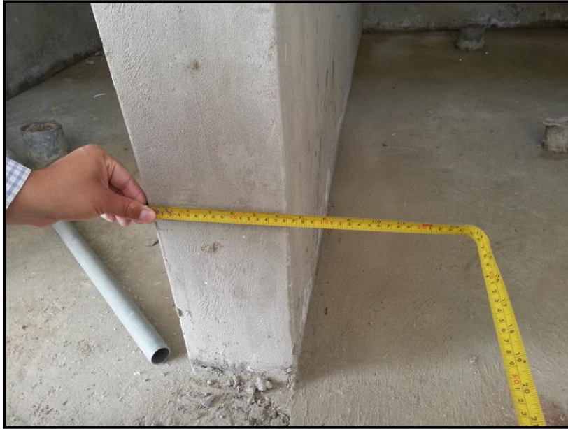
FOTO PROYECTO L. Muro tarrajado con diferencia de espesor en la parte inferior con respecto a la superior.
