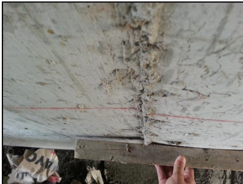
FOTO PROYECTO A. Placa con irregularidades en su superficie (superficie no plana) producto de deficiencias a la hora de asegurar el encofrado.
