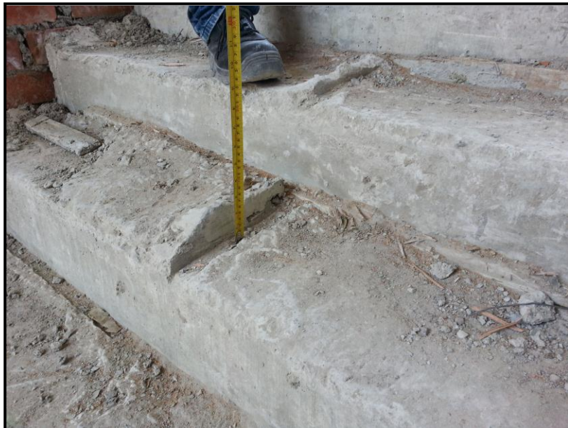
FOTO PROYECTO L. vaciado defectuoso en escaleras.
