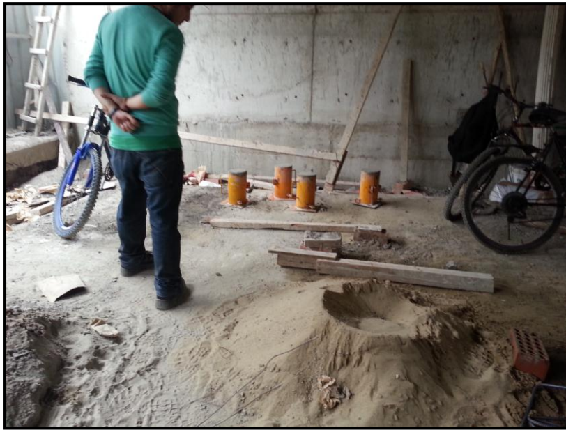
FOTO PROYECTO A. Probetas de concreto sin haber sido sometidas a curado en el tiempo normado.
