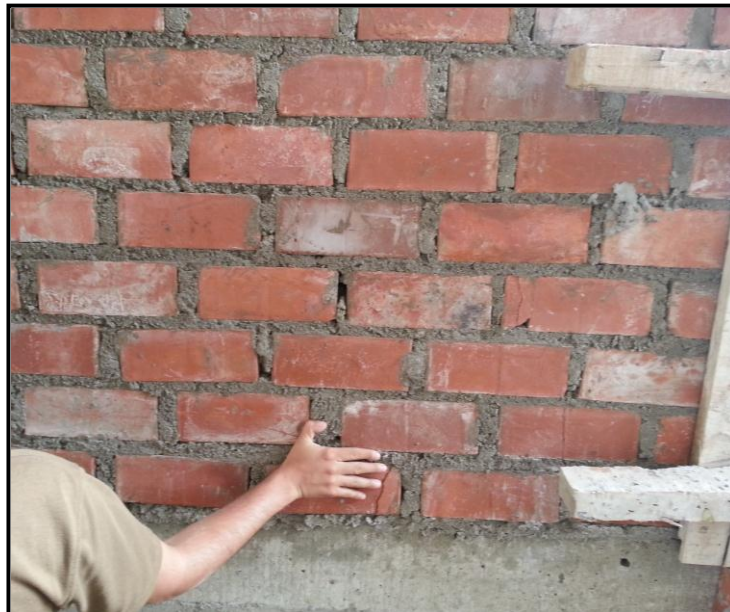
FOTO PROYECTO L. Espesor del mortero en muros mayor a 1.5 cm.
