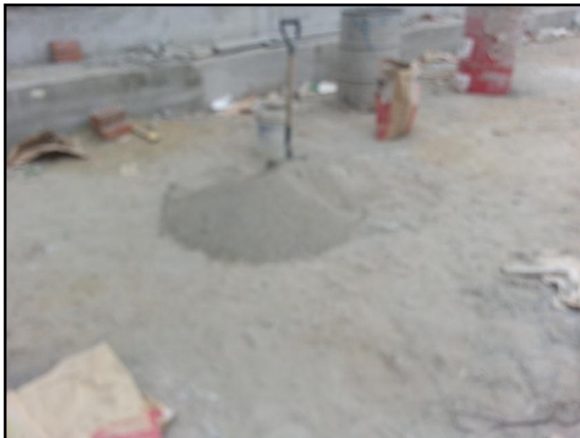
FOTO PROYECTO L. Condiciones inadecuadas de la preparación de la mezcla, en contacto con el suelo.
