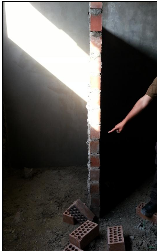
FOTO PROYECTO L. Se puede observar que el muro no está aplomado.
