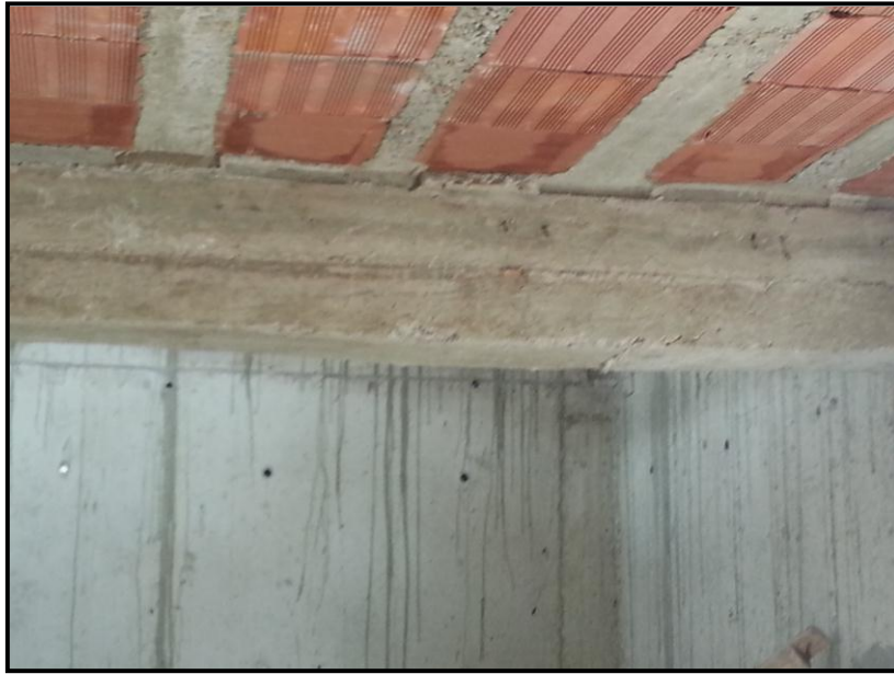
FOTO PROYECTO A. Viga pandeada producto de un encofrado deficiente.
