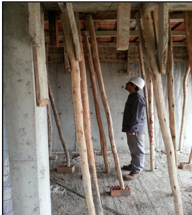
FOTO PROYECTO A. Verticalidad inadecuada de pies derechos.
