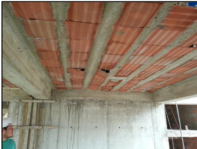
FOTO PROYECTO A. ladrillos de techo salidos debido a mal aseguramiento del encofrado de la losa. También se puede apreciar uniformidad en el espesor de las viguetas.
