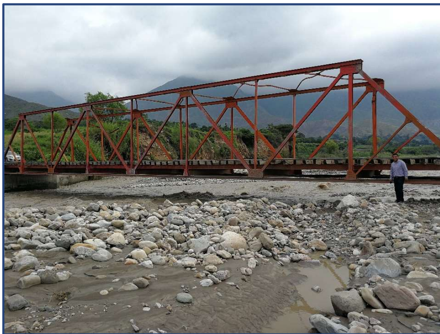
Figura 1. 6: Acumulación de sedimentos en el estribo del puente Chuquillanqui, aguas abajo del puente.
