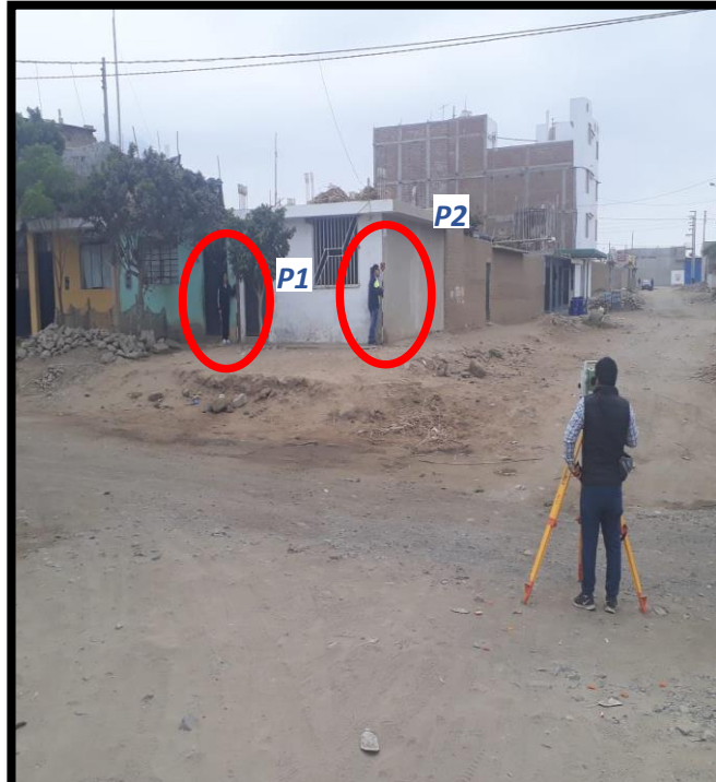
P1: Se toma lectura de la ubicación de las cajas de agua
