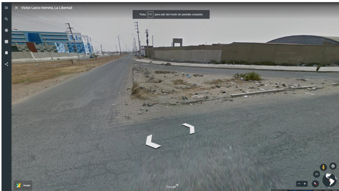
Sardineles en mal estado
