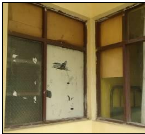
Fotografía nº 16: Ambientes sin utilizar por una inadecuada Zonificación
