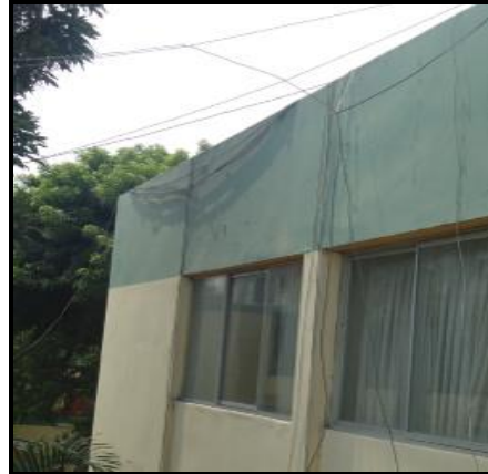
Fotografía nº 14: Inadecuado sistema eléctrico
