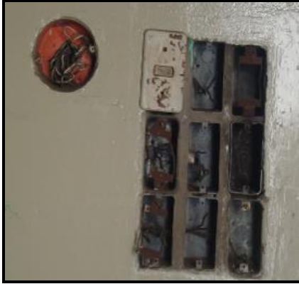
Fotografía nº 11: Inadecuado Sistema de Alumbrado (deteriorado)
