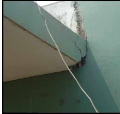
Fotografía nº 12: Techos en mal estado
