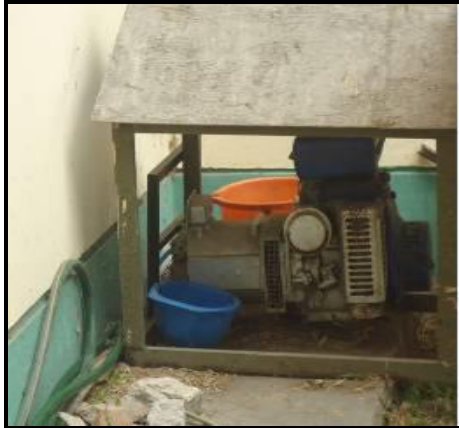
Fotografía nº 13: Ausencia de un cuarto de máquinas.
