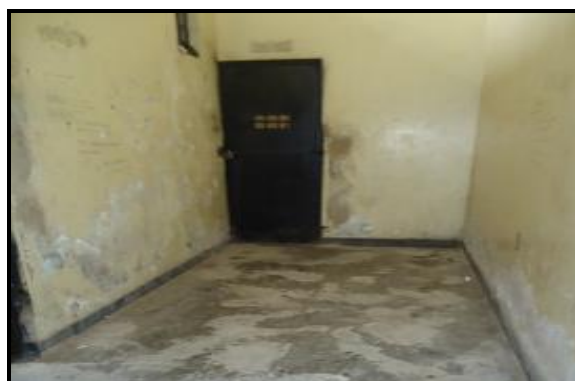
Fotografía nº 10: Cuarto de meditación deteriorado.
