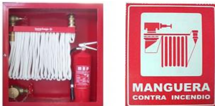
Ilustración N°50: Manguera Contra incendios
