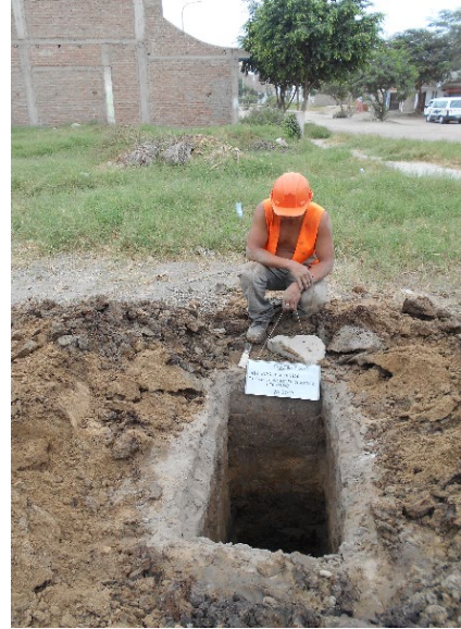
FOTO A-5-09: Vista panorámica de la calicata C-22, ubicada en Mz. “F”, Lote 08, Prolongación Av. Eguren – Urb. Villa del Contador.
