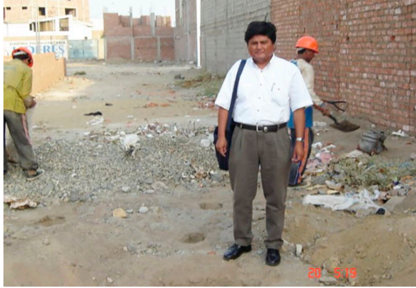
FOTO A-5-07: Vista panorámica de la calicata C-19, ubicada en MZ. “K-1”, Lote 22, Urb. Covicorti.
