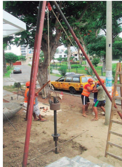
FOTO A-5-20: Vista del sondeo de exploración con el equipo de penetración estándar SPT-6, hasta los 7.50 m., ubicada en Mz. “H-5”, lote 10-11 (Manuel de falla) - Urb. Primavera.
