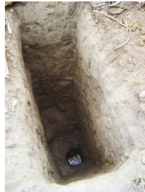
Foto 3. 2 Excavación de calicata realizada por SL DE INGENIERIA EIRL en la Av. Prolongación Gonzales Prada – Urb. Santa María V Etapa – Trujillo
