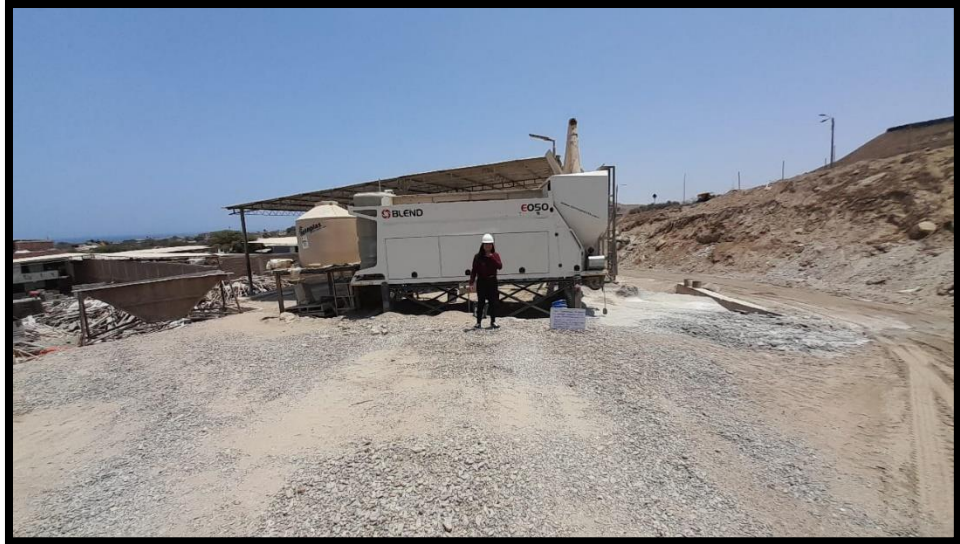
Planta de concreto -Murgisa Servicios Generales S.R.L
