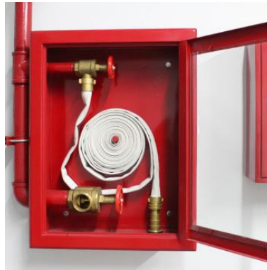
Figura 40: Gabinete contra incendios.
