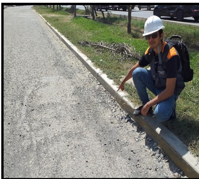
IMAGEN 38 - Perdida de agregados (PA) en la sección UMV-I01
