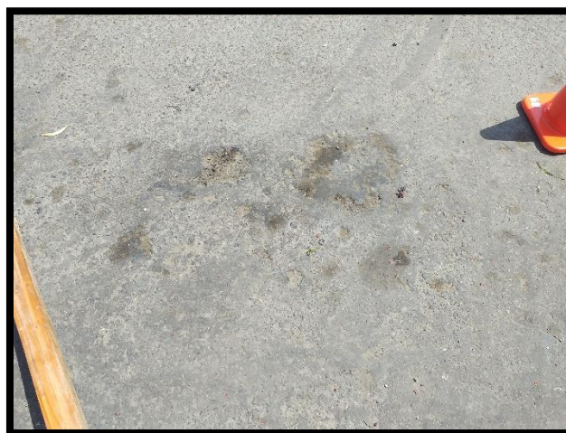
Imagen 03: Falla desprendimiento de agregado - Pról. César Vallejo.
