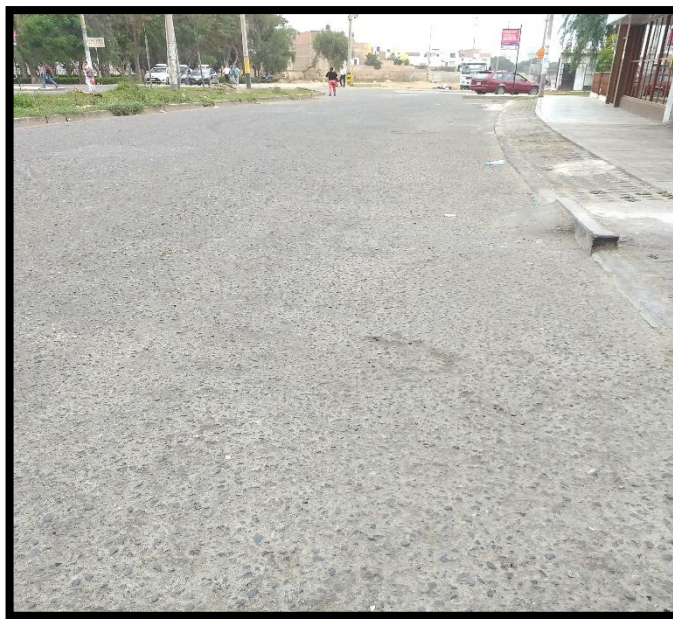
IMAGEN 37 - Pérdida de la película ligante (PL) en el tramo IMV-I01
