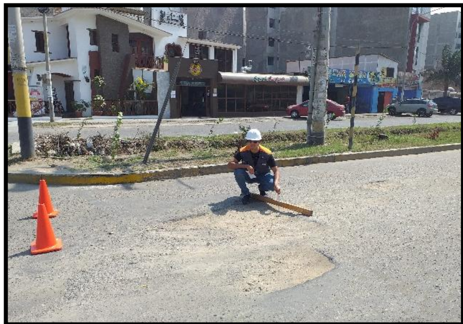
IMAGEN 18 - Medición de profundidad de la falla (hueco)
