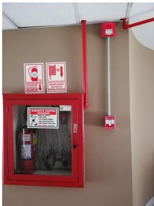
FIGURA N° 111 GABINETE CONTRA INCENDIO
