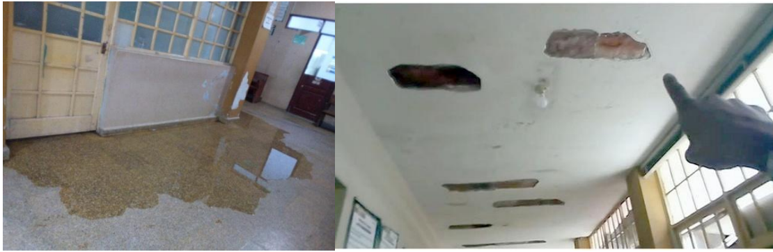
Figura N° 17: Deterioro en la infraestructura del hospital. Fuente: Elaboración propia.
