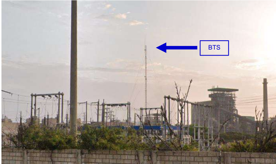
Figura 4: Estación base celular en el interior de la fábrica Trupal
