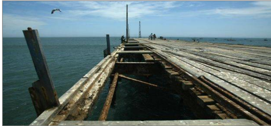
Imagen N°20: Condición actual, deplorable, de abandono en la que se encuentran las estructuras del muelle de Pacasmayo.
