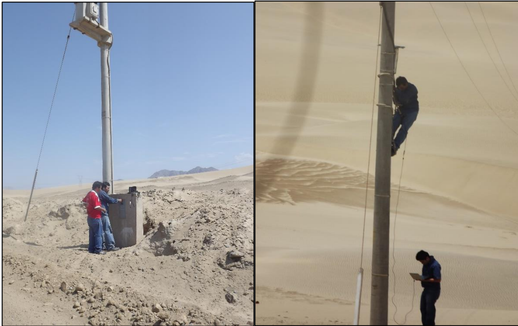
Figura III - 8. Técnicos de CHAVIMOCHIC realizando la toma de lecturas de los medidores eléctricos.
