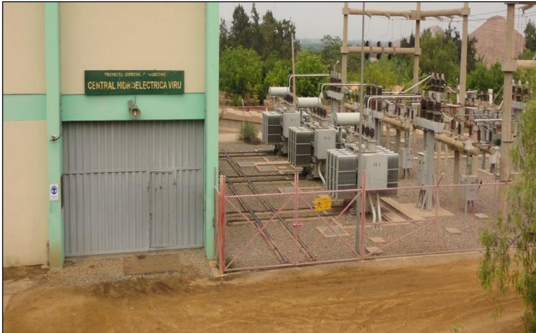
Figura III - 3. Central Hidroeléctrica VIRU
