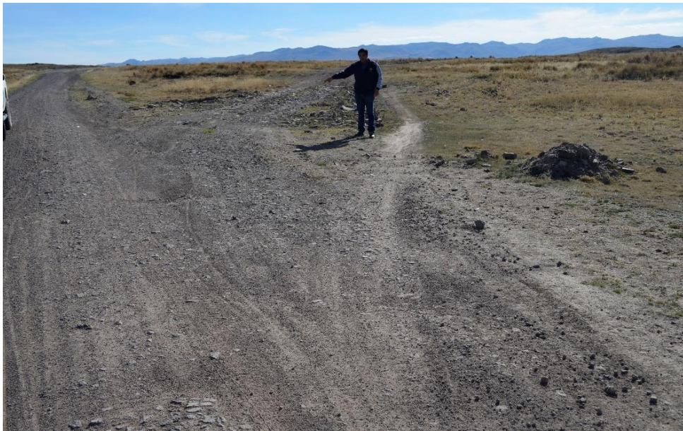
Figura 5: Estado actual de la vía.
