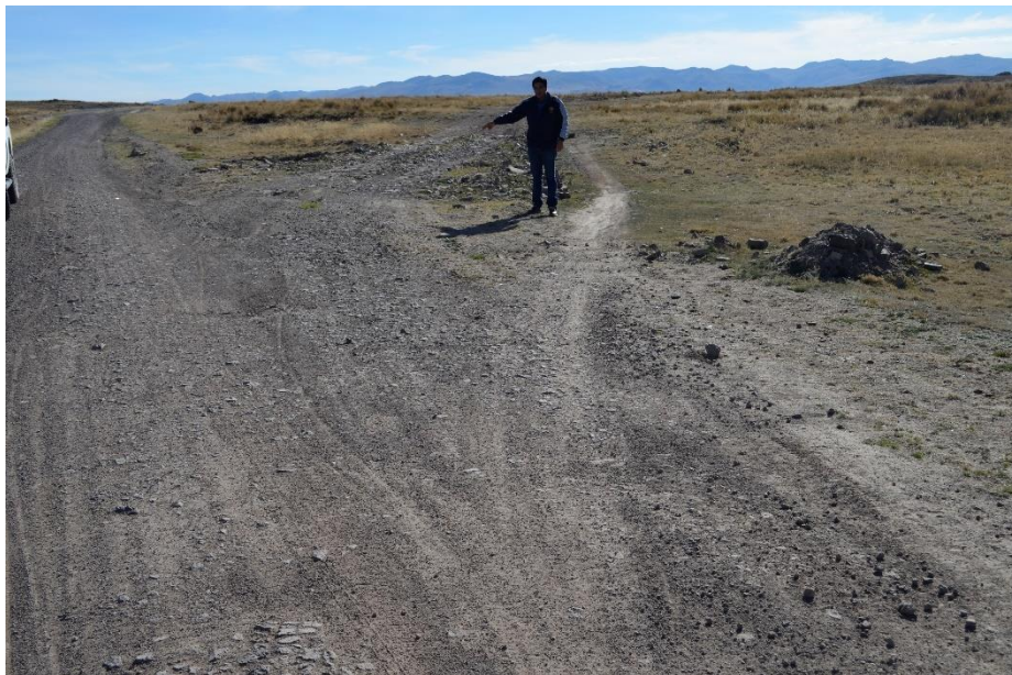
Figura 1: Estado Actual de la Vía.
