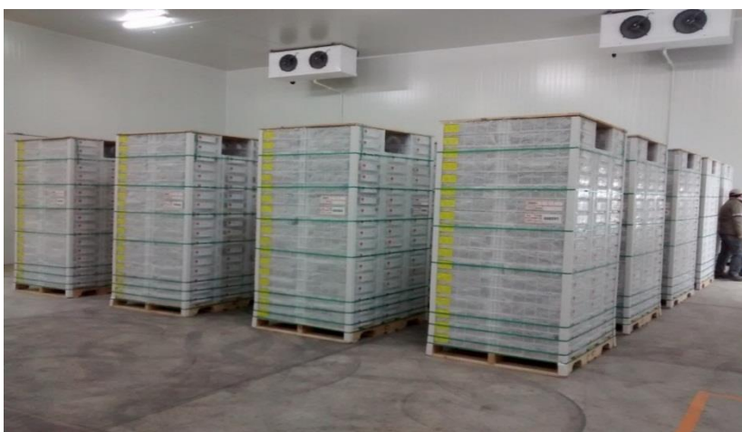
Figura N° 25 Cámara de frío
