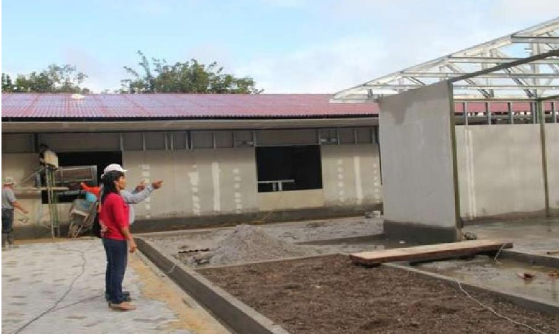
FOTOGRAFÍA N° 3: Construcción de la infraestructura del Colegio de Alto rendimiento San Martín con material prefabricado.
