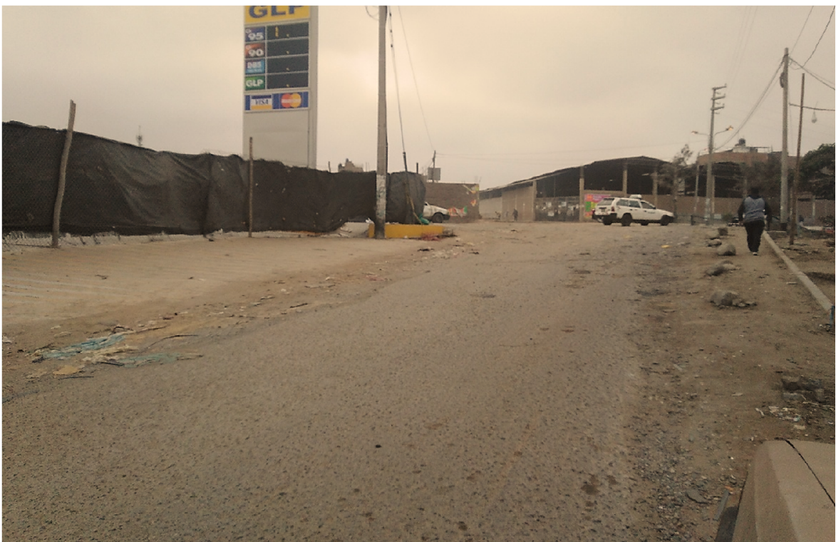
Ilustración 17. Ancho de Carril reducido y sin Asfalto. Ausencia de señalización.
