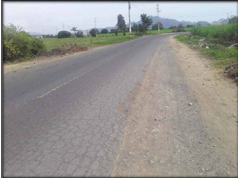
Imagen 08 – Localización de la falla Fuente: Propia
