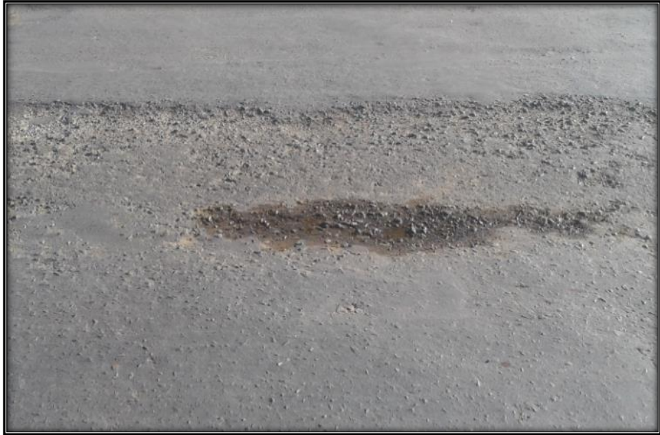
Imagen 09 – Localización de la falla Fuente: Propia
