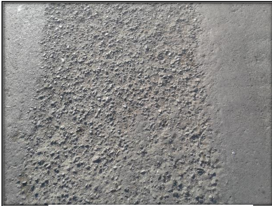
Imagen 10 – Localización de la falla Fuente: Propia
