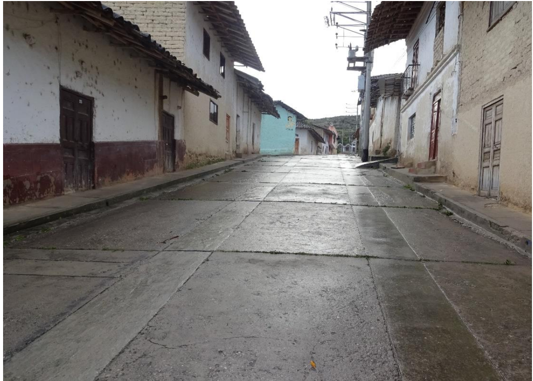
Imagen N° 60. Grietas lineales, parche grande y pulimento de agregados presentes en el Jr. Gonzáles Prada
