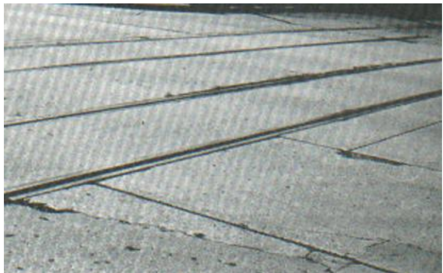
Imagen N°17. Cruce de vía férrea de severidad baja.
