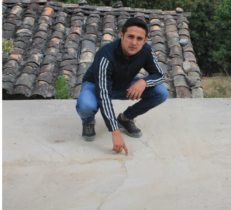
Imagen N° 52 Falla de Tipo Losa Dividida de Severidad Media
