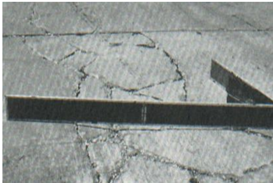
Imagen N°16. Falla por punzonamiento con severidad alta.
