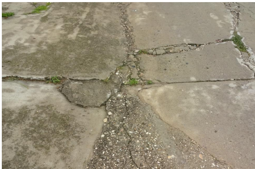
Imagen N° 62. Falla de tipo losa dividida en el Jr. Bolívar
