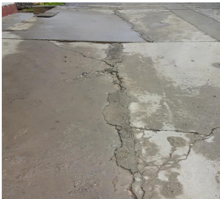
Imagen N° 63. Grietas lineales y levantamientos en el Jr. Manco Cápac
