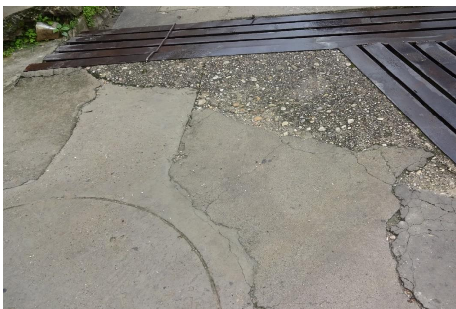
Imagen N° 67. Falla tipo pulimento de agregados y grietas lineales, encontradas en el Jr. Huayna Cápac
