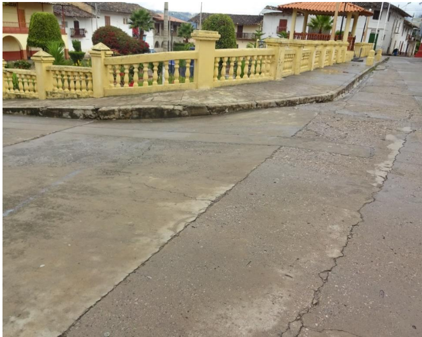
Imagen N°56. Jr. Plaza de Armas con presencia de grietas lineales y falla tipo pulimento de agregados
