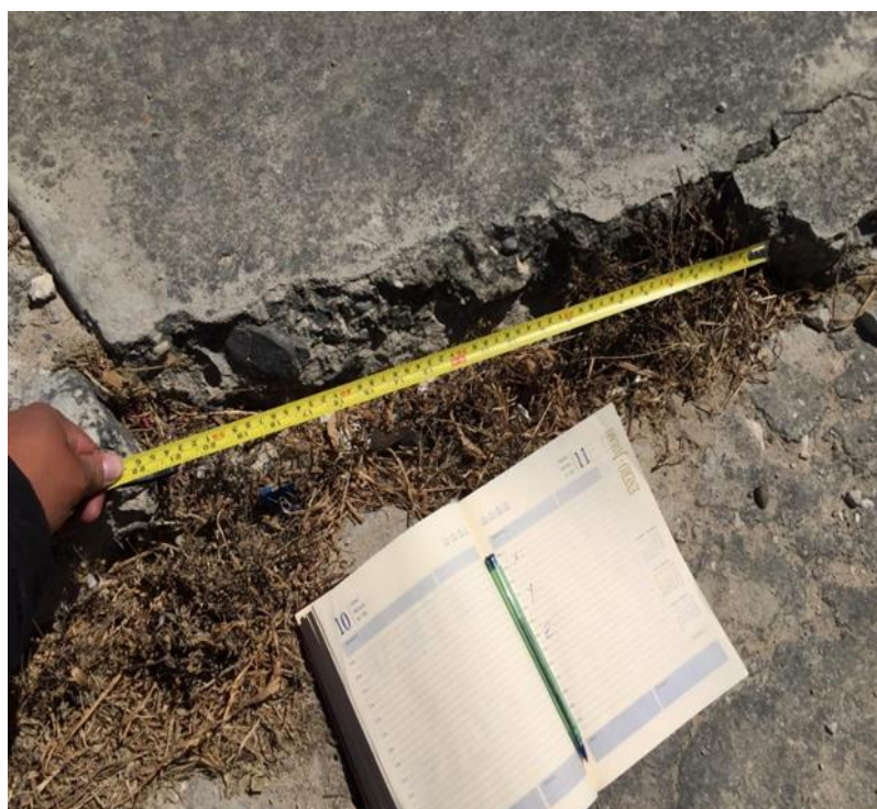
Imagen N° 55. Falla de tipo descascaramiento de junta de severidad media, presente en el Jr. Plaza de Armas
