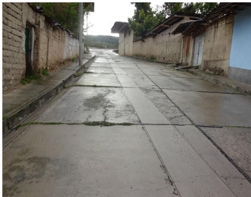
Imagen N° 59. Grietas lineales, parche grande y pulimento de agregados presentes en el Jr. Gonzáles Prada
