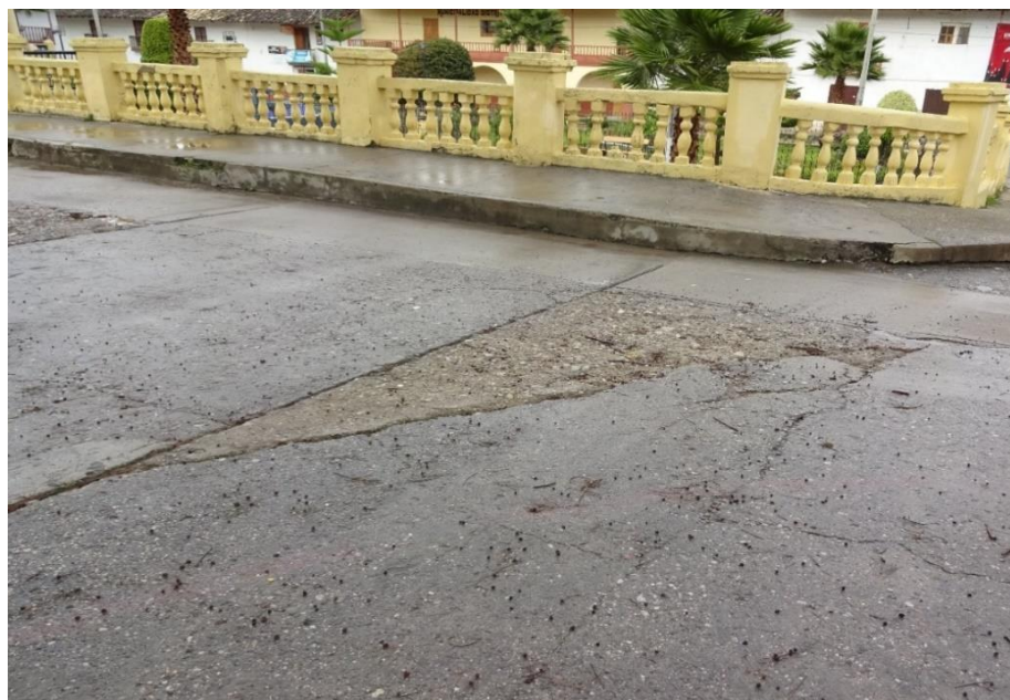
Imagen N° 68. Jr. Plaza de Armas con grieta en esquina, grietas lineales y pulimento de agregados
