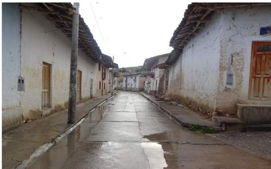
Imagen N° 54 Av. Gonzáles Prada con presencia de Parche Grande y Daño de Sello en las Juntas
