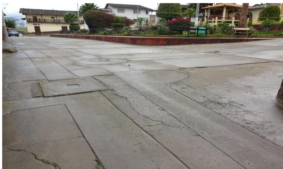
Imagen N° 69. Jr. Plaza de Armas con grietas lineales, desprendimiento de disgregación de áridos y presencia de parche grande
