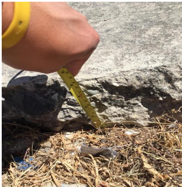
Imagen N° 61. Falla de tipo escala de severidad alta en el Jr. Raimondi
