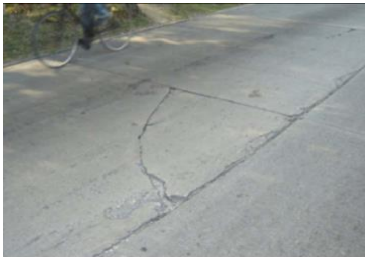
Imagen N°3. Grieta de tipo Esquina de baja severidad
