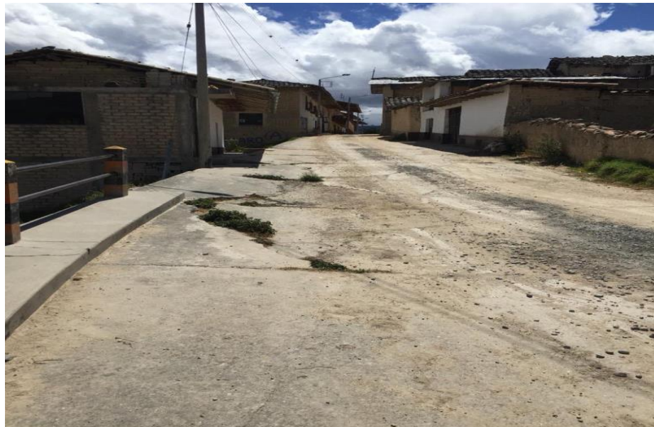
Imagen N° 65. Jr. Raimondi con deterioro de juntas, escala, levantamientos, losas divididas y grietas lineales
