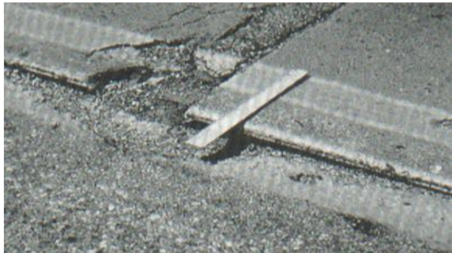
Imagen N° 8. Desnivel en calzada de severidad media
