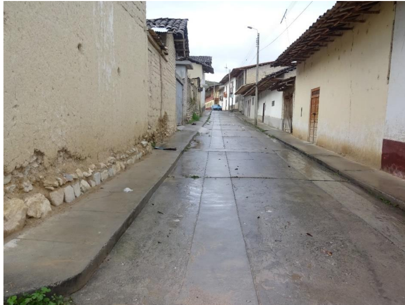
Imagen N° 58. Falla de tipo parche grande presente en el Jr. Sucre
