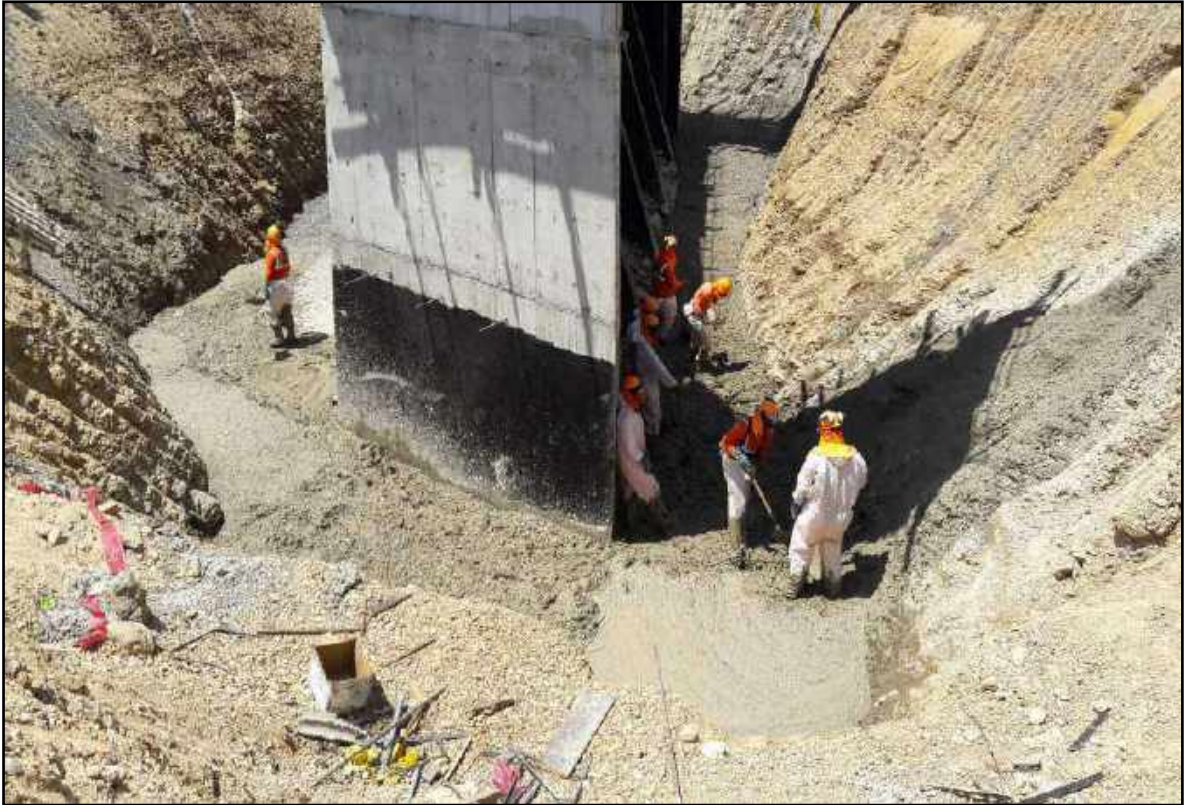
Fotografía N° 07: Vaciado de relleno fluido en zanja alrededor de la zapata sobre la capa granular
