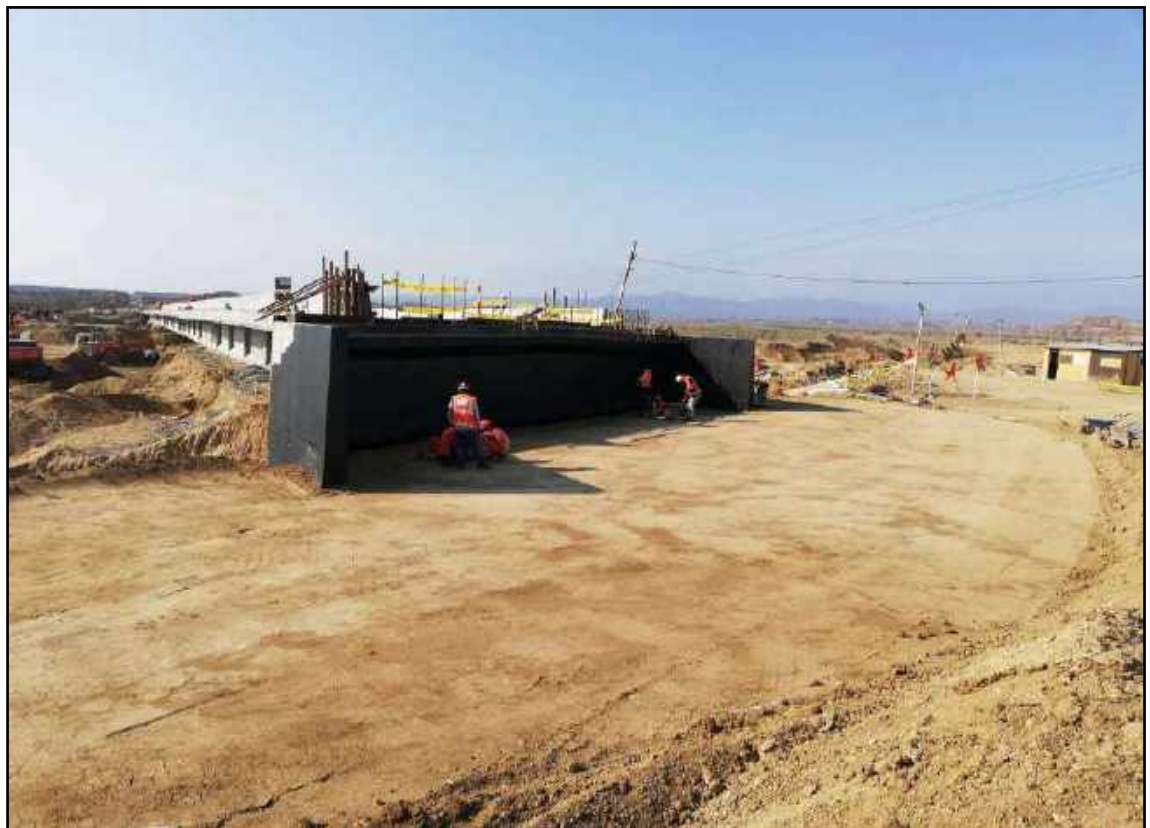
Fotografía N° 18: Vista del control de densidad en la última capa de relleno estructural en el Estribo Izquierdo
