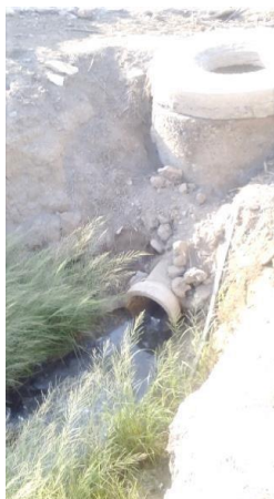
Ilustración 13: Se observa que la descarga final que llega a un canal existente de Nazareno
