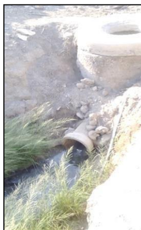
Ilustración 3 : Descarga de aguas residuales al canal existente
