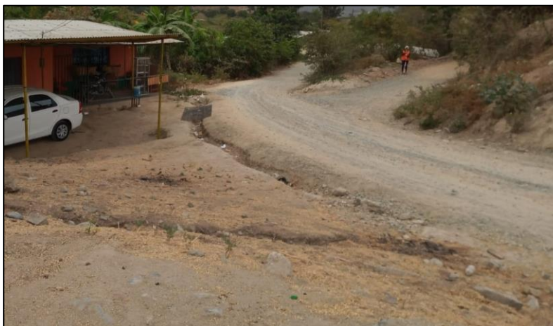
Figura 5: Estado actual de la vía, falta de drenaje pluvial
