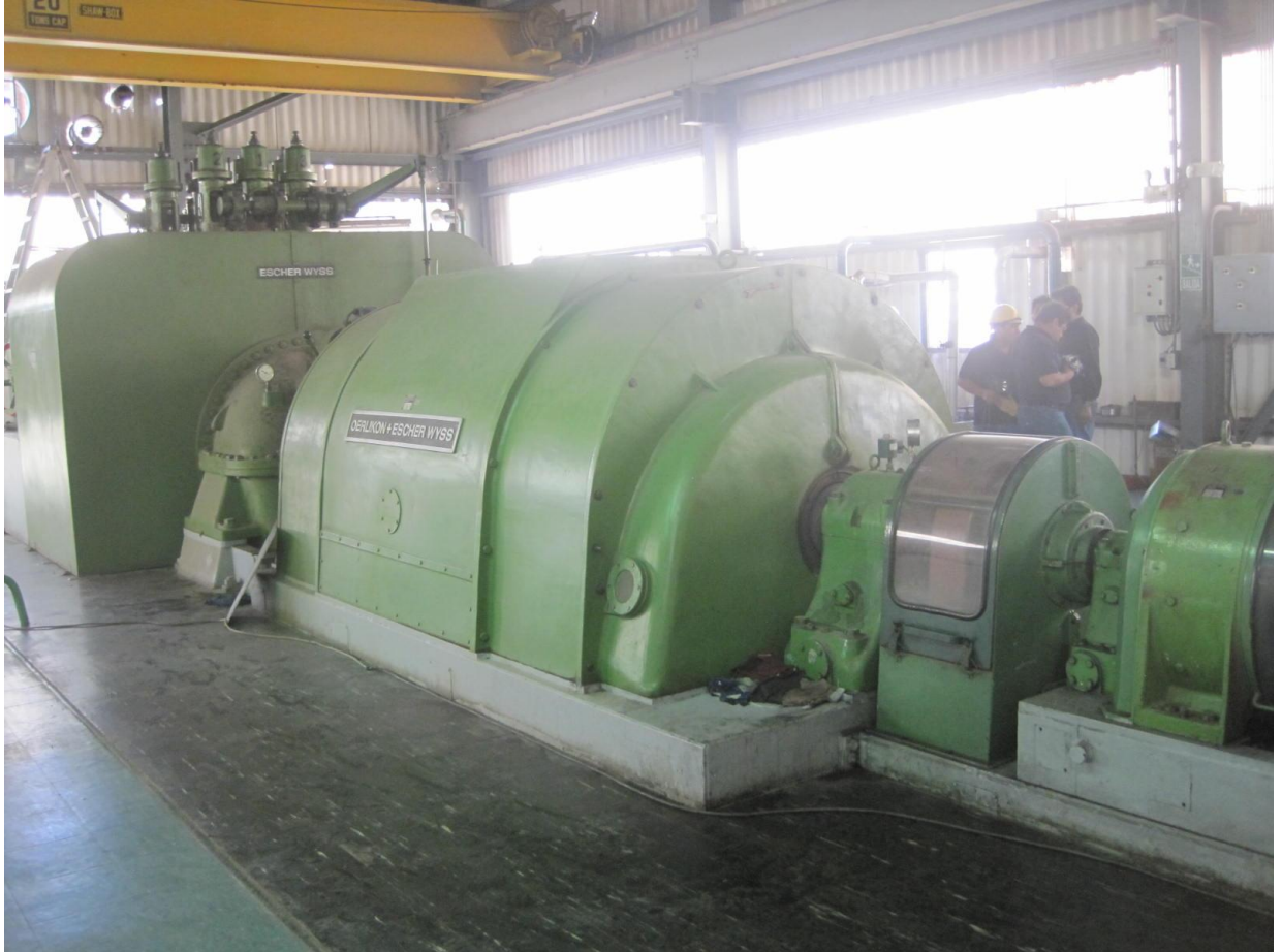
Fig. 3.7 Turbogenerador de 13.8KV.
